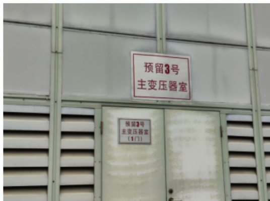
站内预留 3#主变位置
