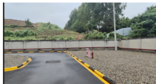
现有事故油池(右侧碎石层下)
