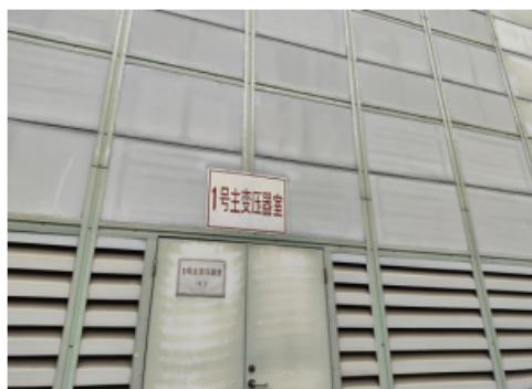
1#主变室吸音墙及消音百叶窗
