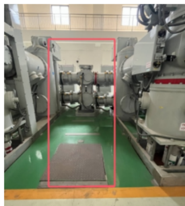
110kV 间隔预留位置
