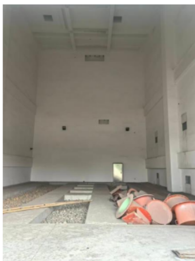
3 号主变预留位置
