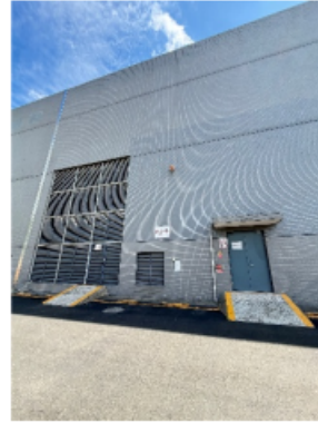
2 号主变隔声门、吸音墙及消音百叶窗
