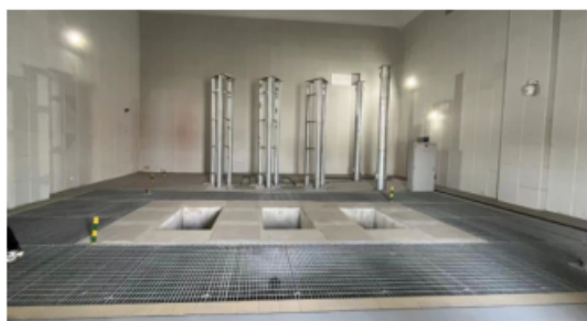
3 号主变预留位置
