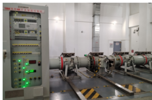
110kV 间隔预留位置
