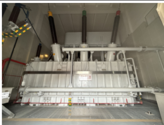
1 号主变及吸音墙
