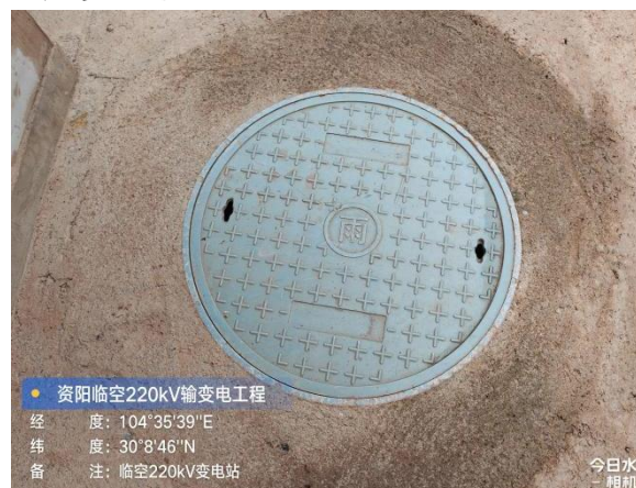
变电站主体工程区站内排水管
