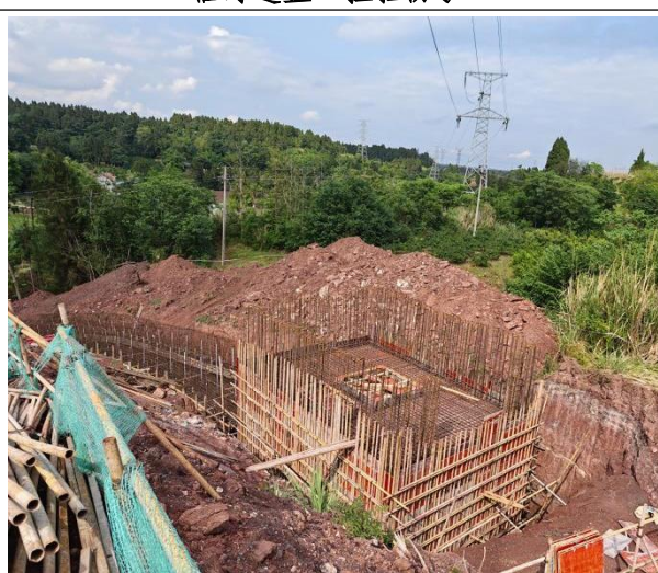
电缆工程回填土、表土堆放散乱，未进行临时 拦挡及苫盖
