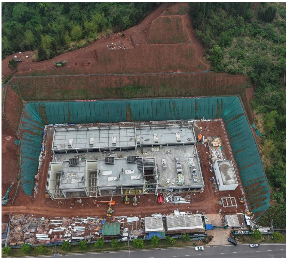
临空 220kV 变电站建设现状
