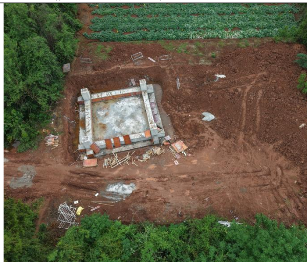
NB13 塔基开挖土石方及表土堆放散乱，未采取 临时遮盖、拦挡防护
