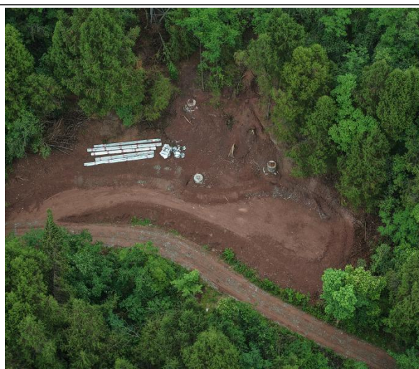
NA11塔基周边和汽运道路内侧未采取临时排水 措施，汽运道路未采取铺垫保护
