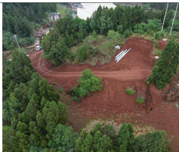
NB23汽运道路边坡未采取遮盖和拦挡防护，道 路内侧未设临时排水沟
