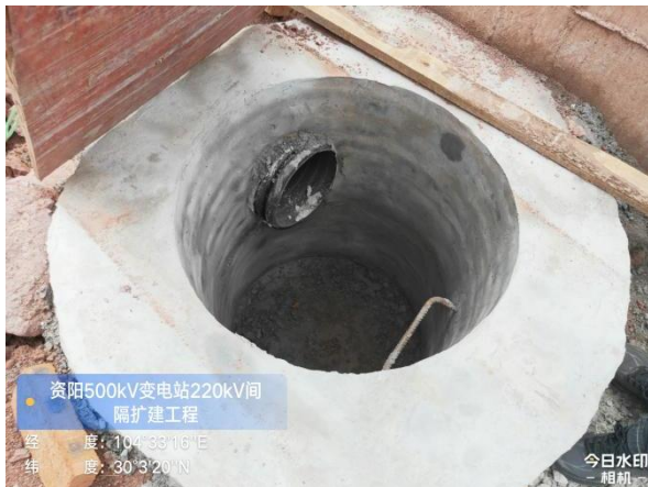
间隔扩建区站区排水管
