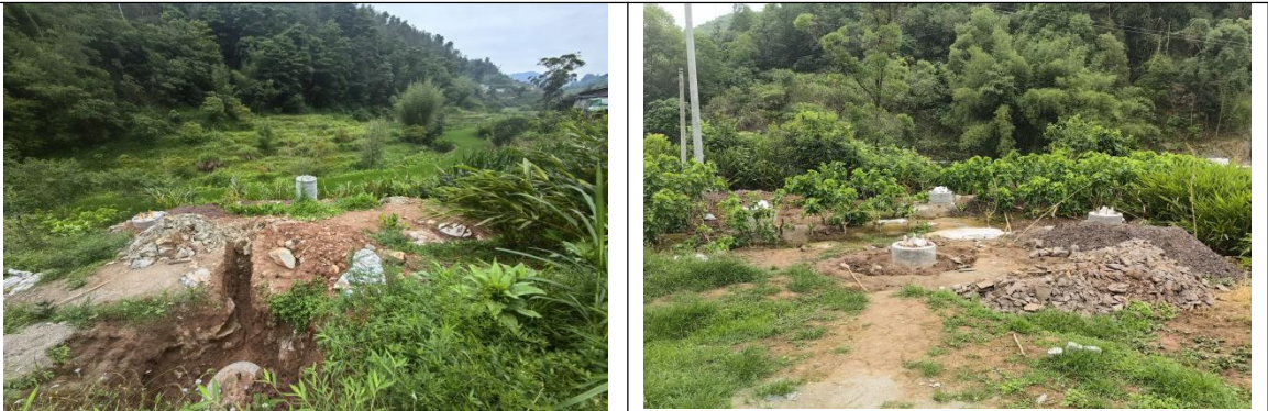
施工过程中缺少临时防护措施
