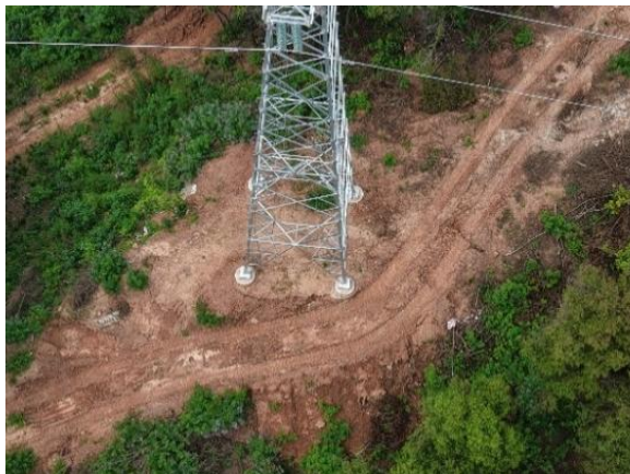
文龙一线 \pi 接线路 N6 塔汽运道路、塔基及施工临时占地未及时采取土地整治和植被恢复
