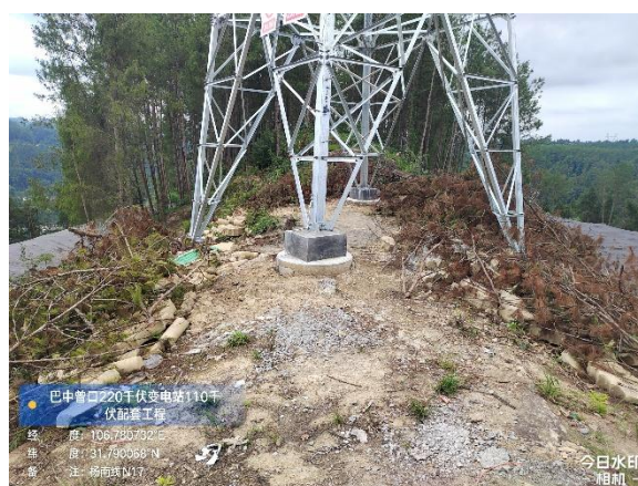
杨南改接线路 N17 塔块石堆放散乱, 塔基及其施工临时占地未及时进行植被恢复
