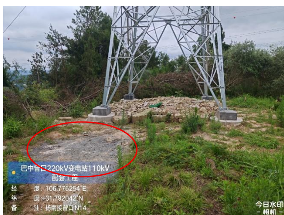
杨南改接线路 N14 塔砂石余料未清理, 塔基未及时进行覆土、土地整治、植被恢复
