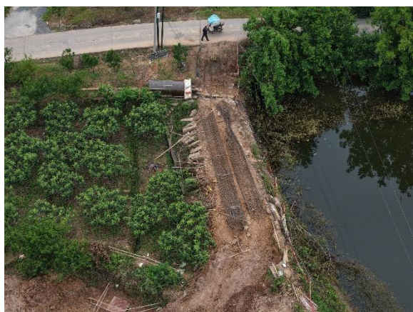
通杨 \pi 接线路 N3 塔汽运道路未采取铺垫保护
