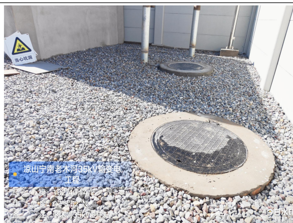
老木河站内碎石地坪、排水管
