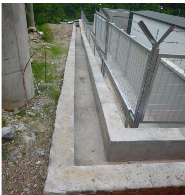
老木河站站外排水沟
