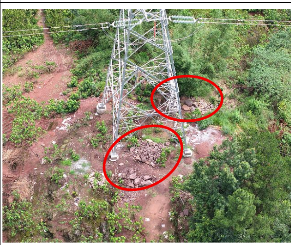
BN3 塔基余土(石)堆放散乱；植被恢复不到位
