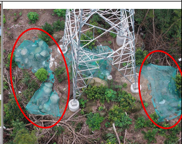
AN12 塔基余土(石)堆放散乱, 植被恢复不到位
