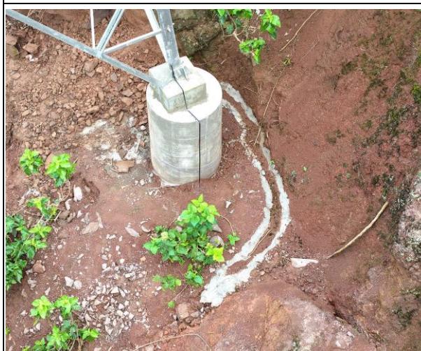
BN2 植被恢复不到位，排水沟淤堵且未接入自然排水系统
