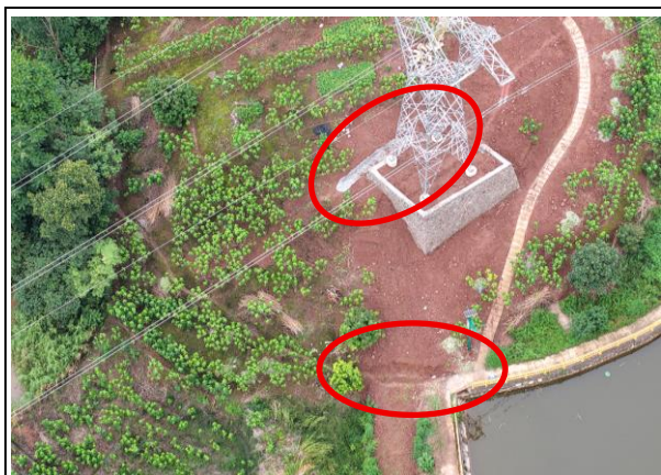
AN24 塔基施工临时占地余土淤堵、损坏鱼塘排洪沟；塔基内植被恢复不及时
