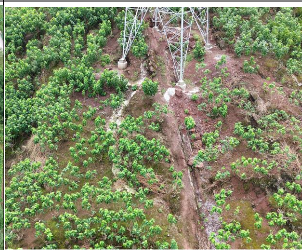
AN21 塔基余土(石)堆放散乱、淤堵原有沟渠, 植被恢复不到位
