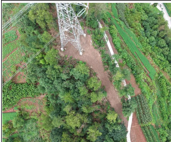
AN18 塔基及其施工临时占地、汽运道路 植被恢复不到位
