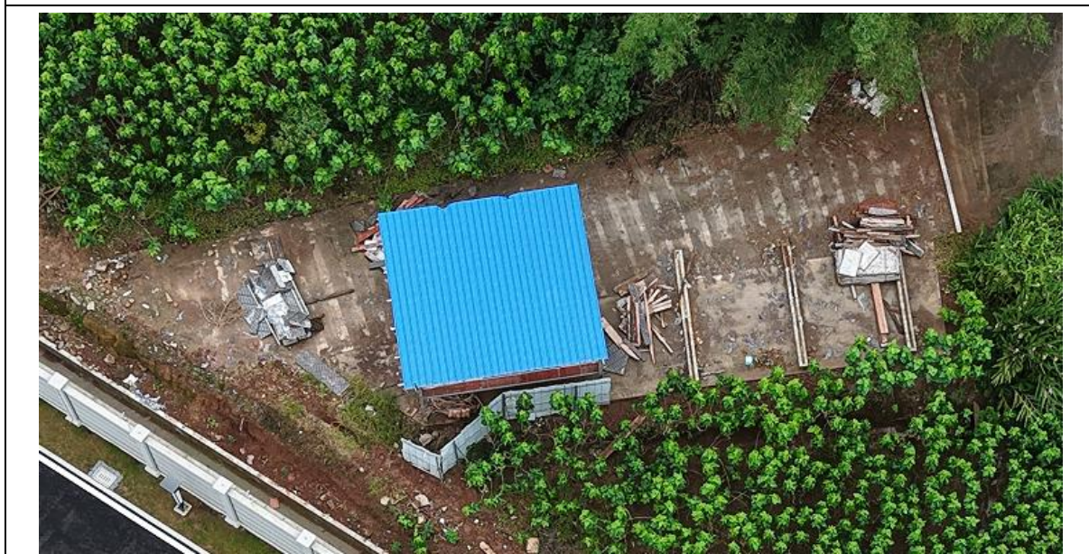
站外西南侧施工临时占地施工工棚未拆除，未迹地恢复
