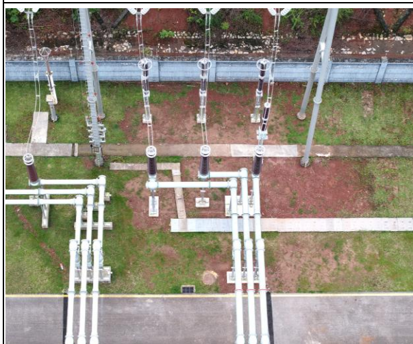
叙府 500kV 变电站间隔 植被恢复不到位
