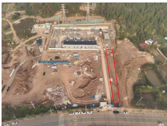
图4.1-1变电站进站道路边坡受其他项目施工侵扰较为严重，裸露地表缺乏有效的临时遮盖
