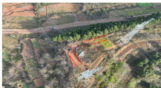
2、古城—双福I、II回 \pi 入德阳南220kV线路NA17塔位施工道路现状
