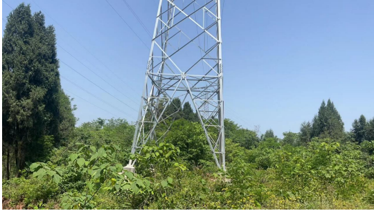
桂花-福德 35kV 线路工程 N2
