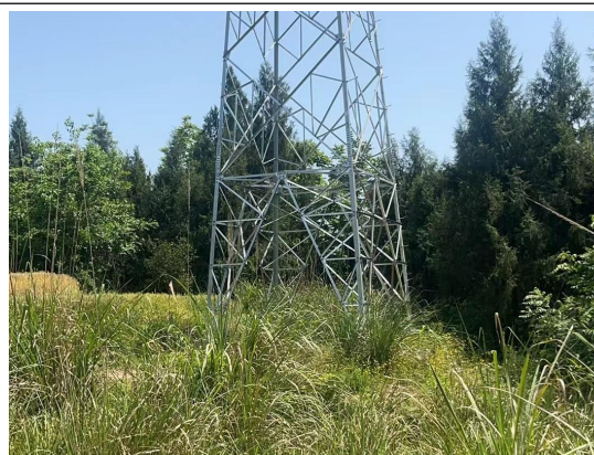
星火-福德 35kV 线路工程 N12
