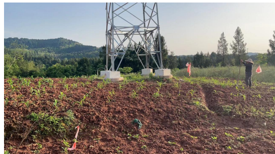
桂花-福德 35kV 线路工程 N22
