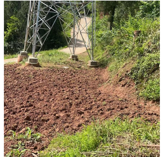
星火-福德 35kV 线路工程 N11
