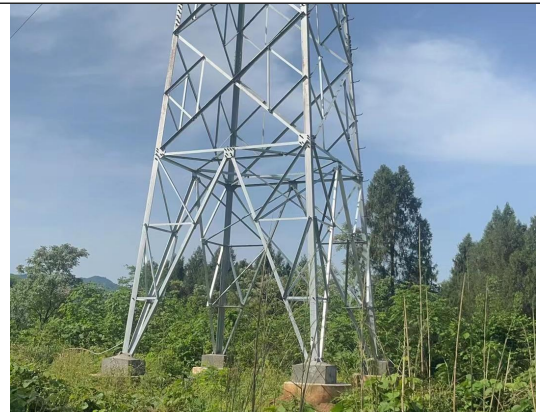
星火-福德 35kV 线路工程 N14
