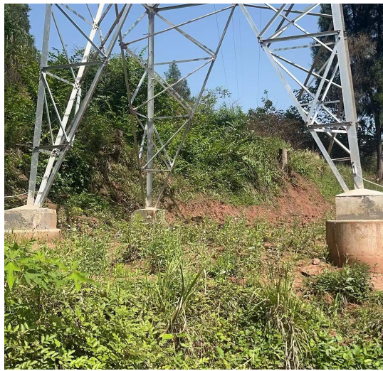
星火-福德 35kV 线路工程 N10
