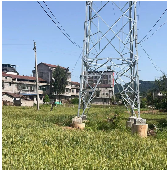
星火-福德 35kV 线路工程 N7
