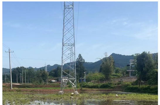
星火-福德 35kV 线路工程 N4
