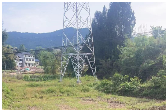
星火-福德 35kV 线路工程 N3
