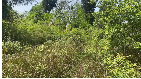
桂花-福德 35kV 线路工程 N3
