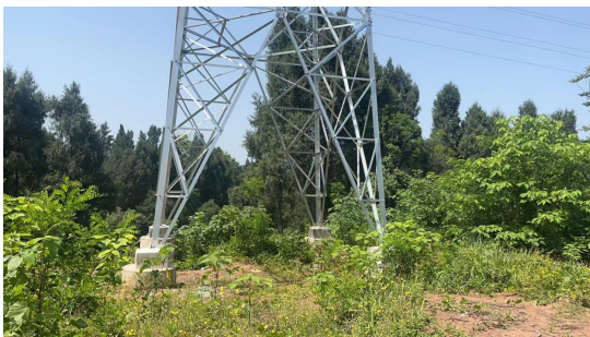
桂花-福德 35kV 线路工程 N7
