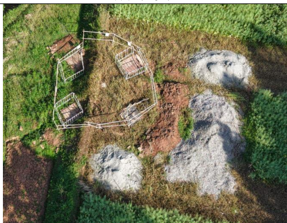
通杨 \pi 接线路 N11 塔砂石料堆放散乱且无铺垫、遮盖
