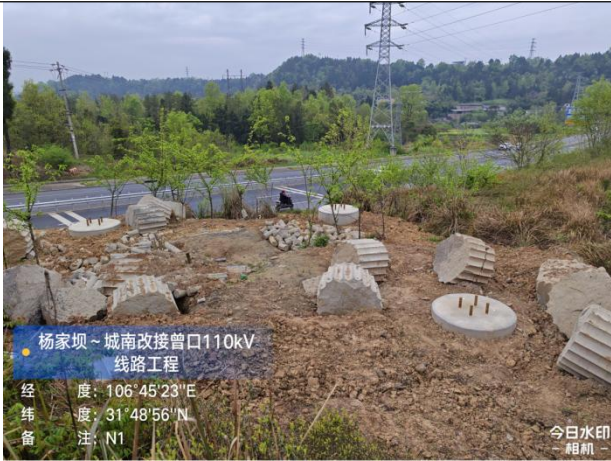
杨南改接线路 N1 塔基础开挖石块未及时清理
