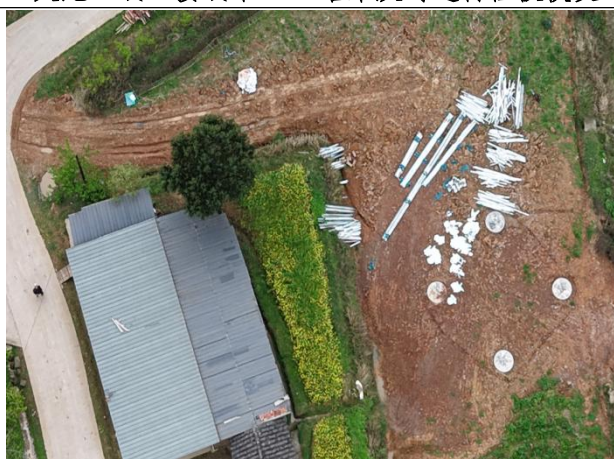
通杨 \pi 接线路 N18 塔汽运道路未采取铺垫措施
