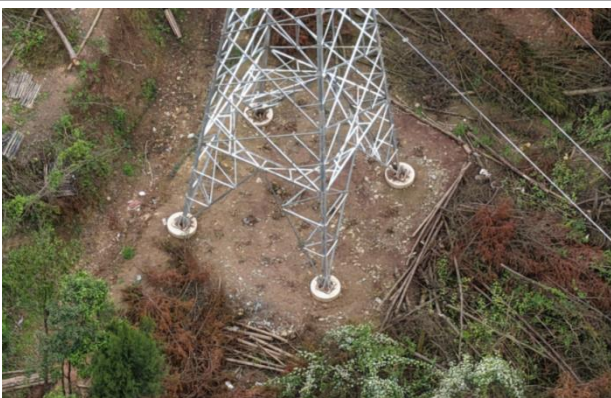
文龙一线 \pi 接线路 N4 塔未及时进行植被恢复
