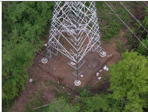
文龙二线 \pi 接线路 N17 塔未及时进行植被恢复
