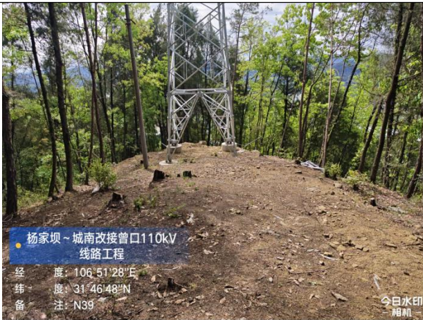
杨南改接线路 N39 塔未及时采取土地整治、植被恢复
