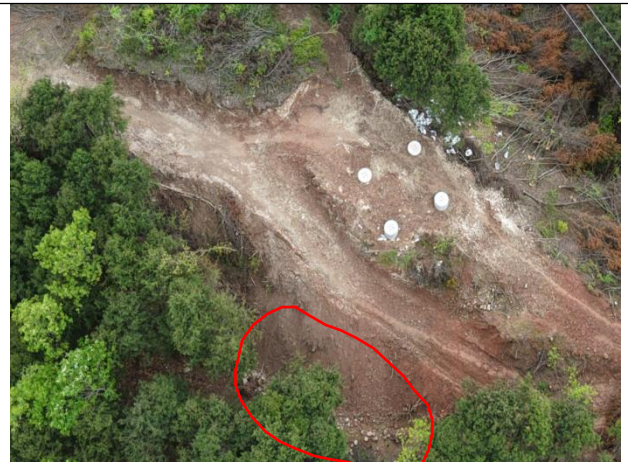
杨南改接线路 N53 新修汽运道路未设置临时排水、沉沙、拦挡, 未采取苫盖措施
