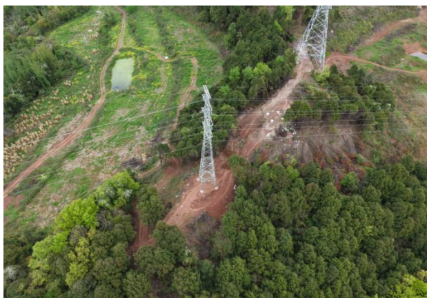
文龙一线 \pi 接线路 N6 汽运道路未及时进行植被恢复
