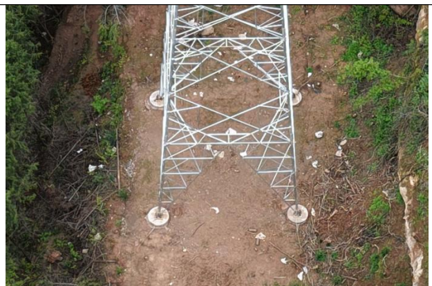
文龙一线 \pi 接线路 N5 塔未及时进行植被恢复
