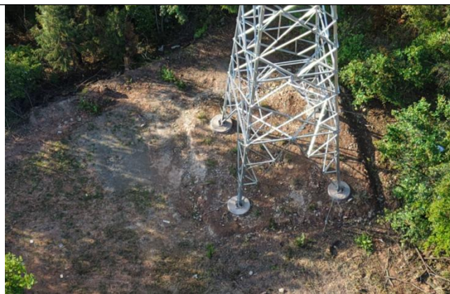
文龙二线 \pi 接线路 N5 塔砂石料未清理，植被恢复不到位
