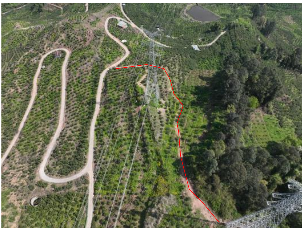
兴梦-鹤山、高埂-鹤山 61 号施工道路未恢复
