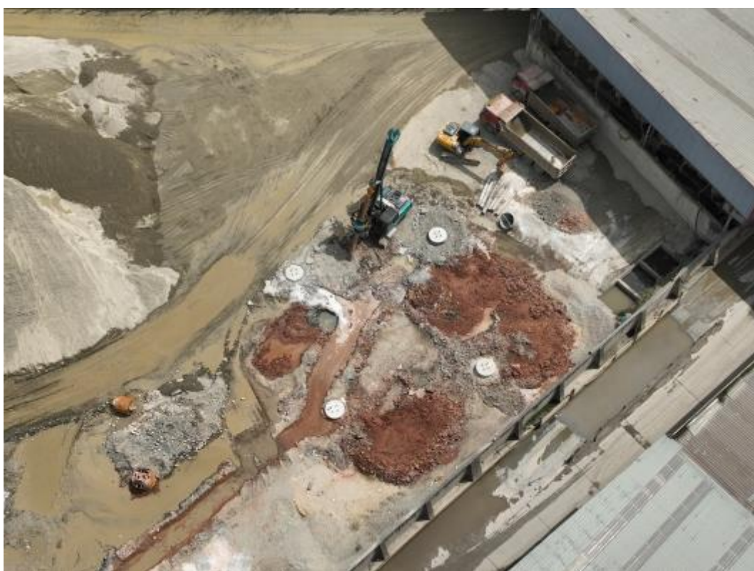
兴梦-鹤山 9 号临时措施未落实
