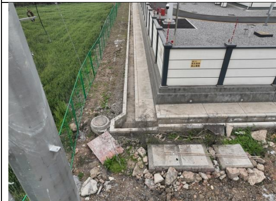
变电站站外排水
