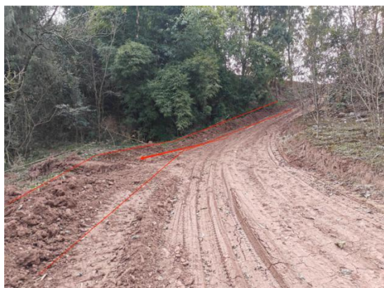
图5-3 N88塔基施工道路表土剥离不到位
