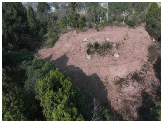
图5-4 N24塔基苫盖不到位
