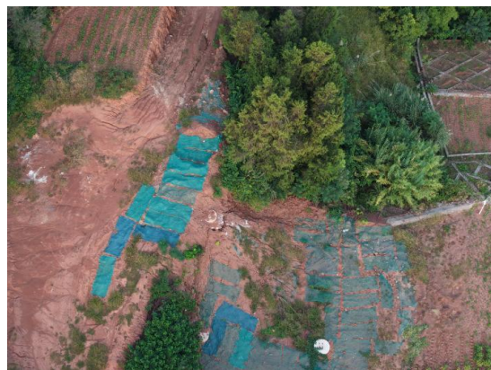
图5-2 N6塔基苫盖不到位
