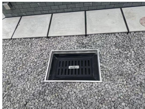
变电站主体区箅子排水口（2026年2月）
