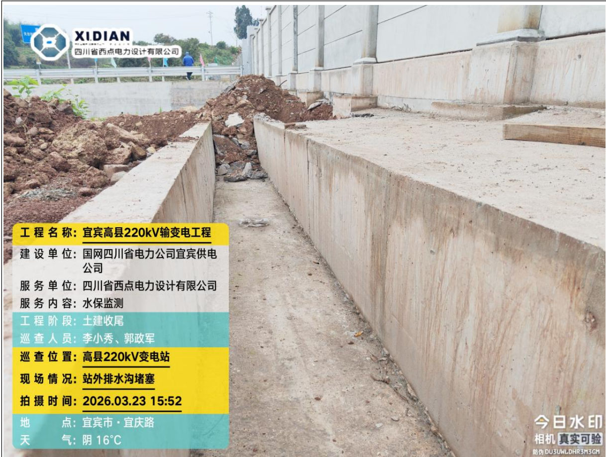
南侧站外排水沟堵塞
