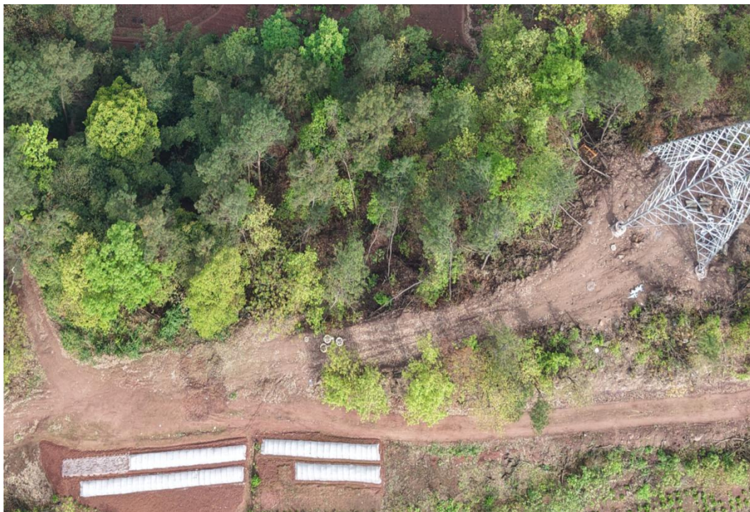
AN18 塔基及其施工临时占地、汽运道路未进行表土回覆、土地整治及植被恢复
