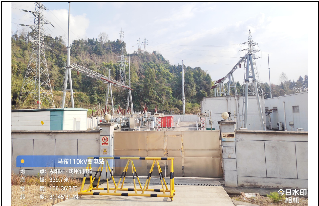
马鞍 110kV 变电站现状
