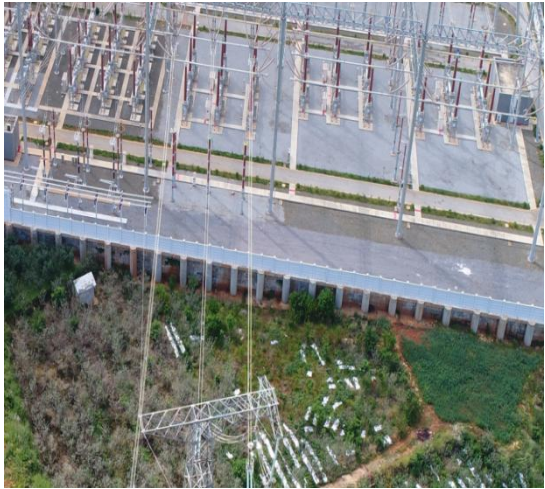
东侧融冰开关区域现状
