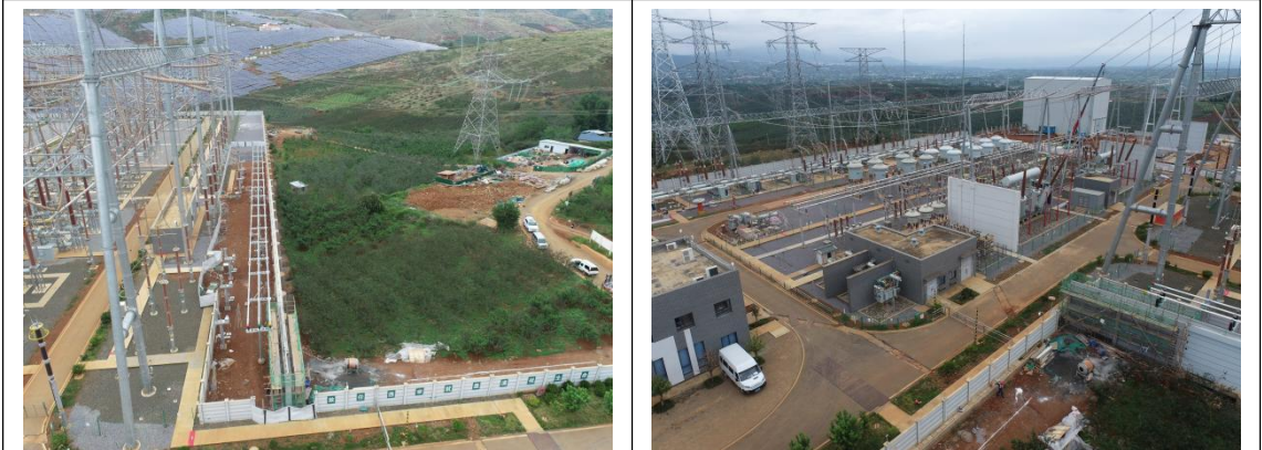
融冰开关改造区域现状
