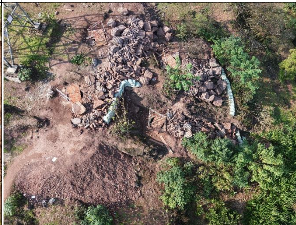
TN1 表土临时拦挡、苫盖落实不及时
