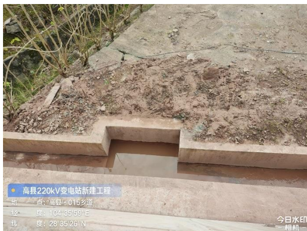
站外沉沙池（南侧）
