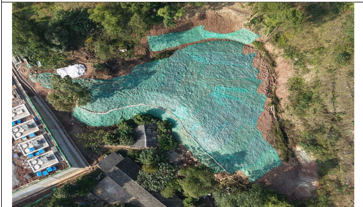
站外东北侧临时堆土区域未采取界限措施，临时拦挡、苫盖措施不足
