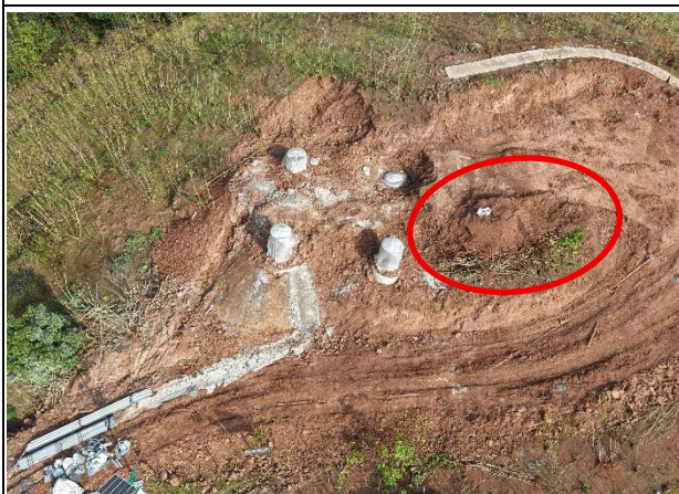
AN24 建渣未清理、表土无临时苫盖措施
