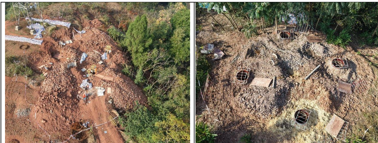
AN2 未剥离表土，临时堆土苫盖、拦挡不及时，存在顺坡溜渣
