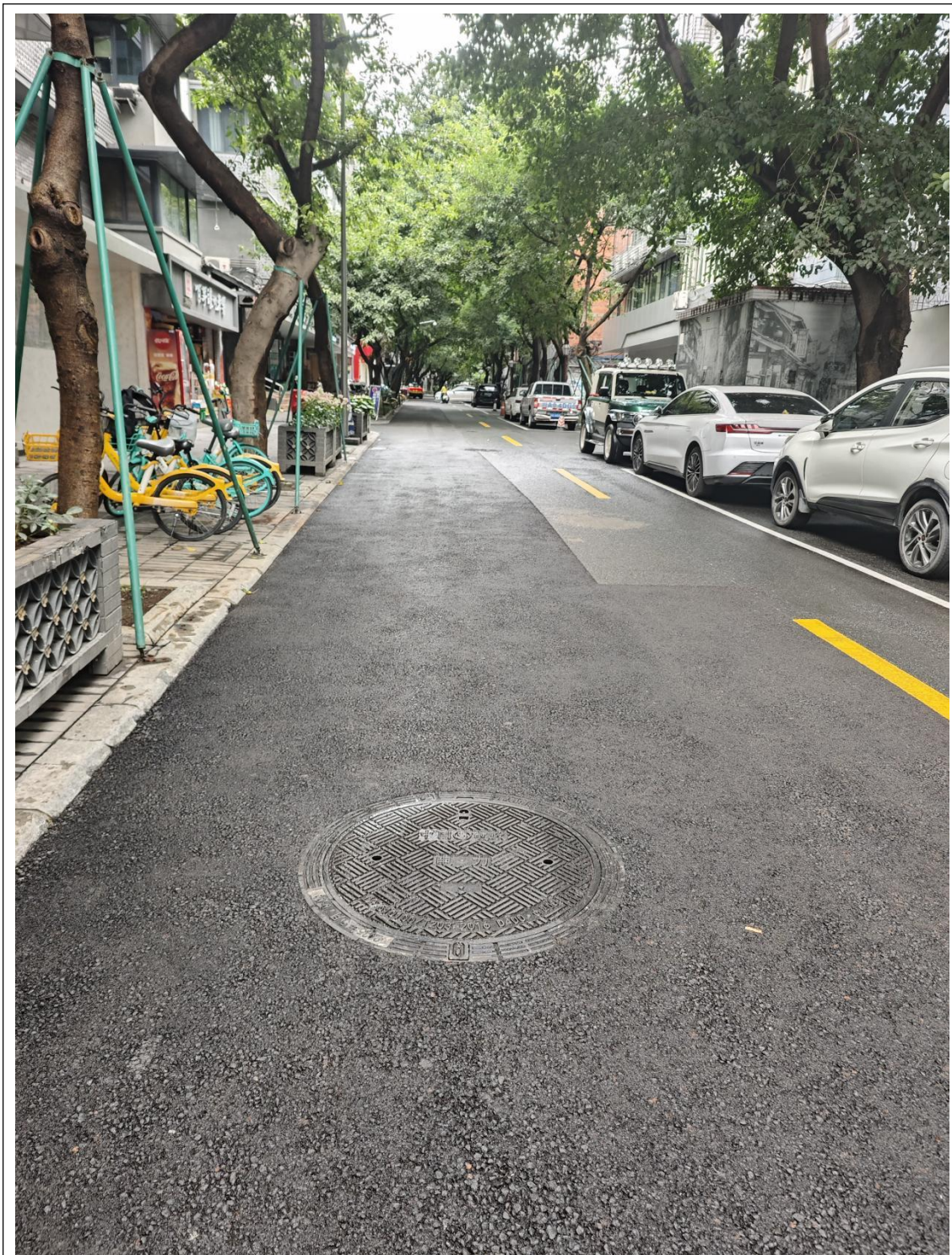
电缆通道（已恢复）2（青羊区多子巷）
