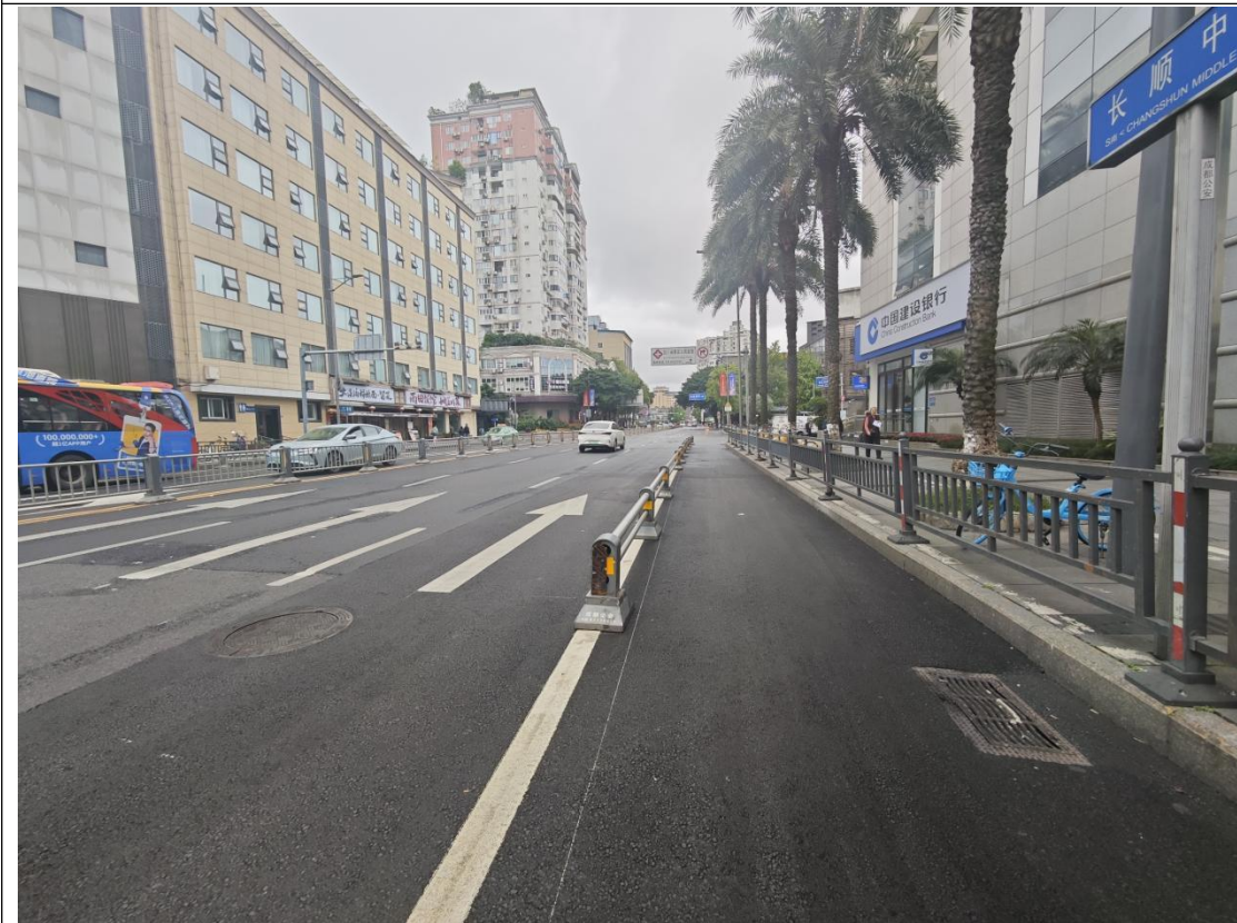
电缆通道（已恢复）3（青羊区长顺中街）
