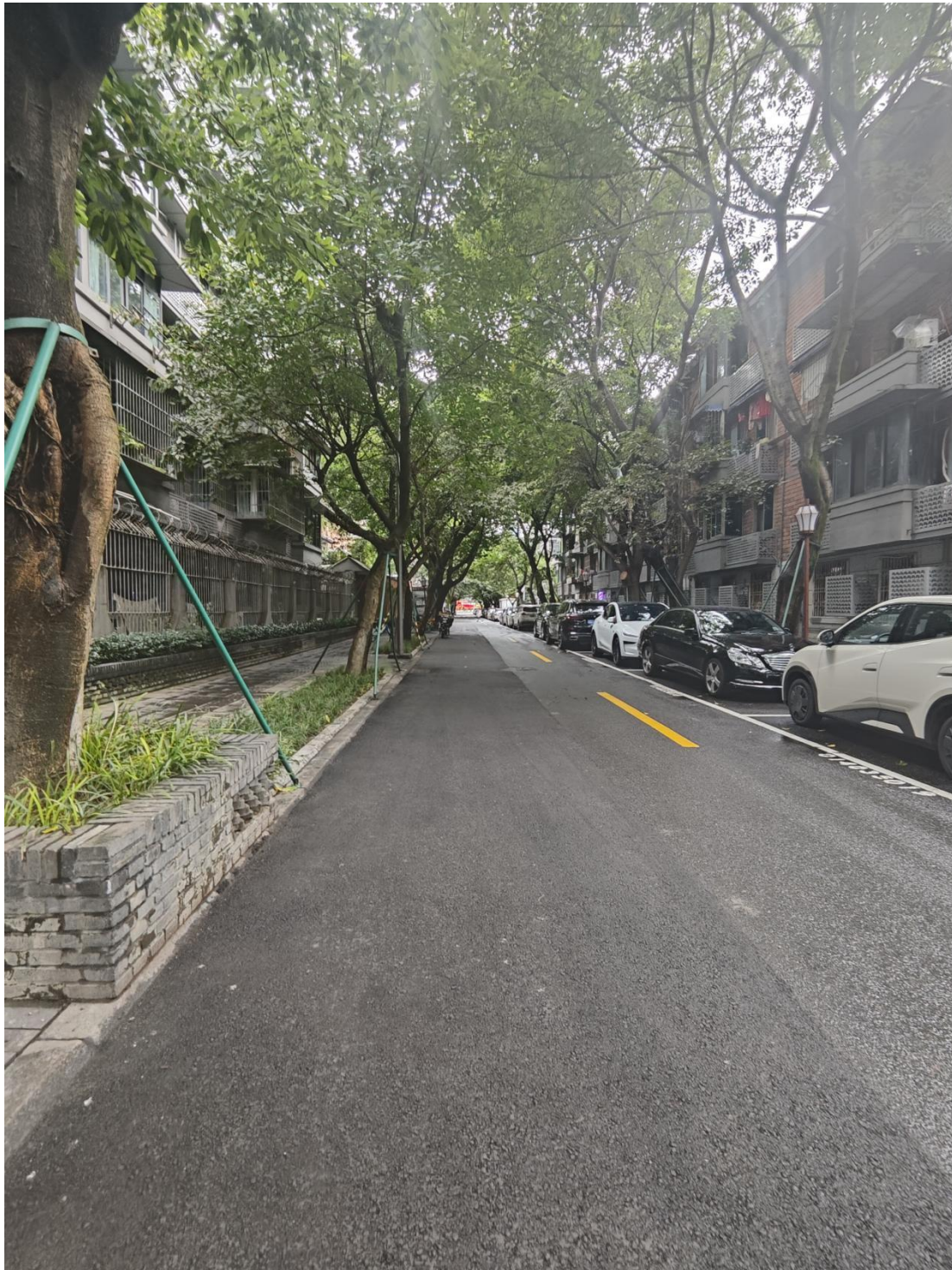
电缆通道（已恢复）1（青羊区多子巷）
