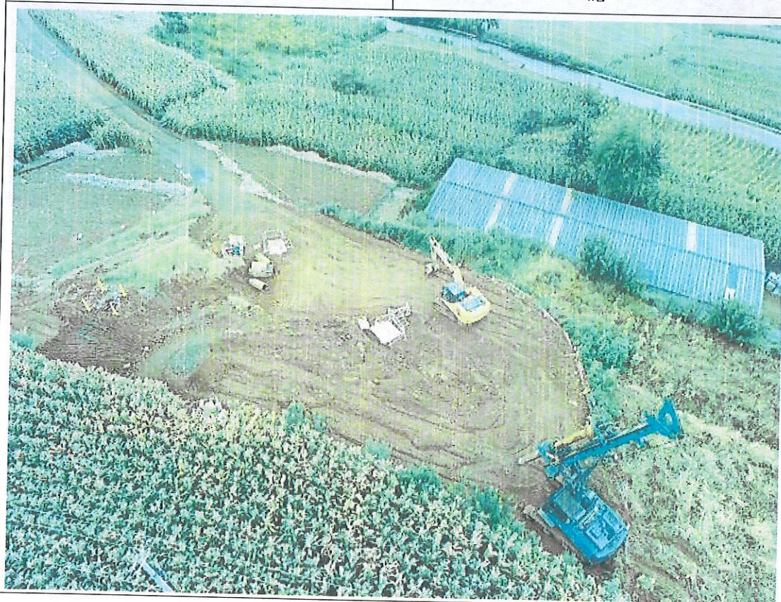
NA135 未见表土防护措施
