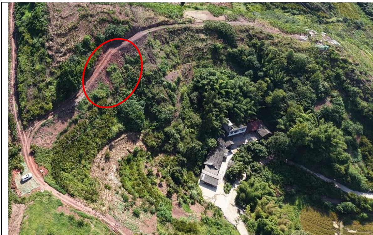
B1 汽运道路 未进行表土剥离，内侧未设置临时排水沟，外侧坡面临时拦挡、临时苫盖措施落实不及时，部分区域存在溜渣现象
