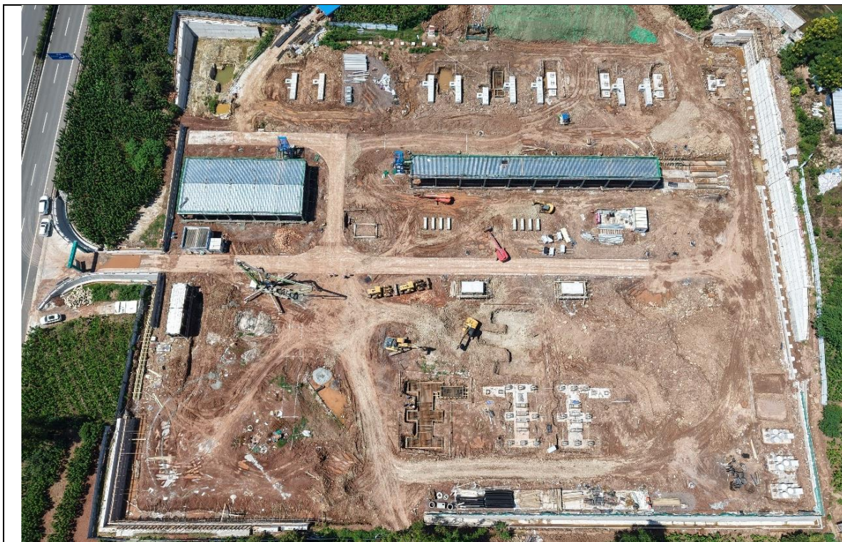
站内闲置施工裸露地表、临时堆土苫盖不及时
