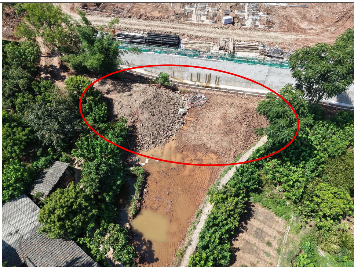
站外临时堆土区域临时拦挡、排水、苫盖措施落实不及时，堆土区域未限界
