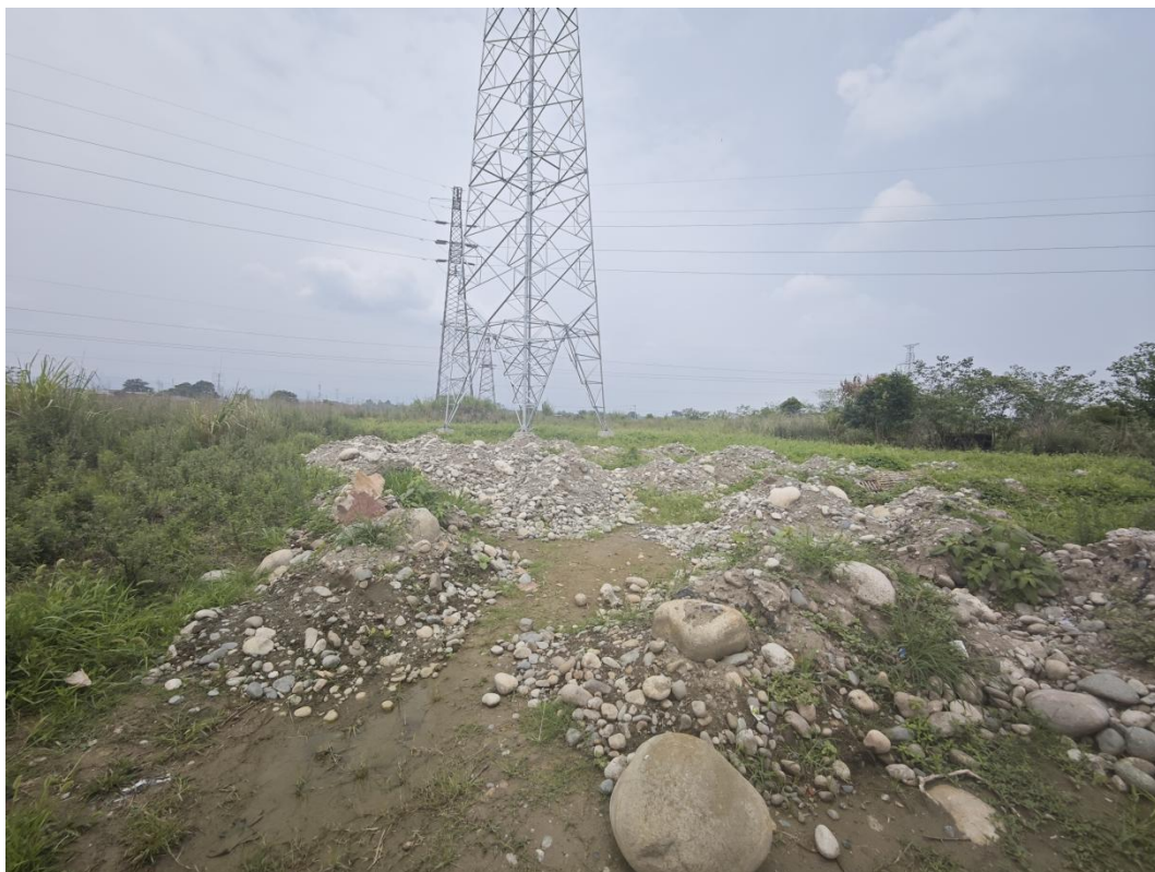
N20 塔基施工区域存在堆弃的土石方无遮盖措施
