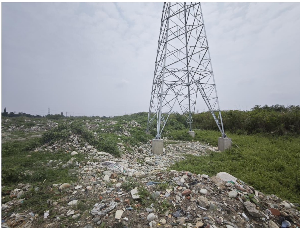
N19 塔基施工区域存在堆弃的土石方无遮盖措施、塔基永久占地区域植被恢复差
