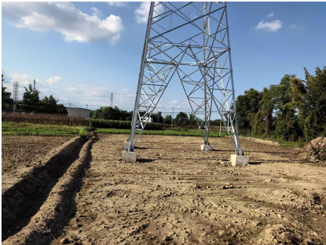
N15 塔基永久占地区域植被恢复差
