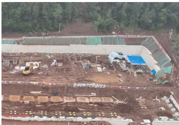
图 4.2-1 变电站新建工程区边坡未绿化
