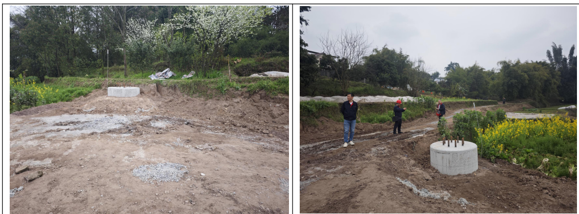
基础已浇筑完成塔基区域（缺乏临时苫盖）
