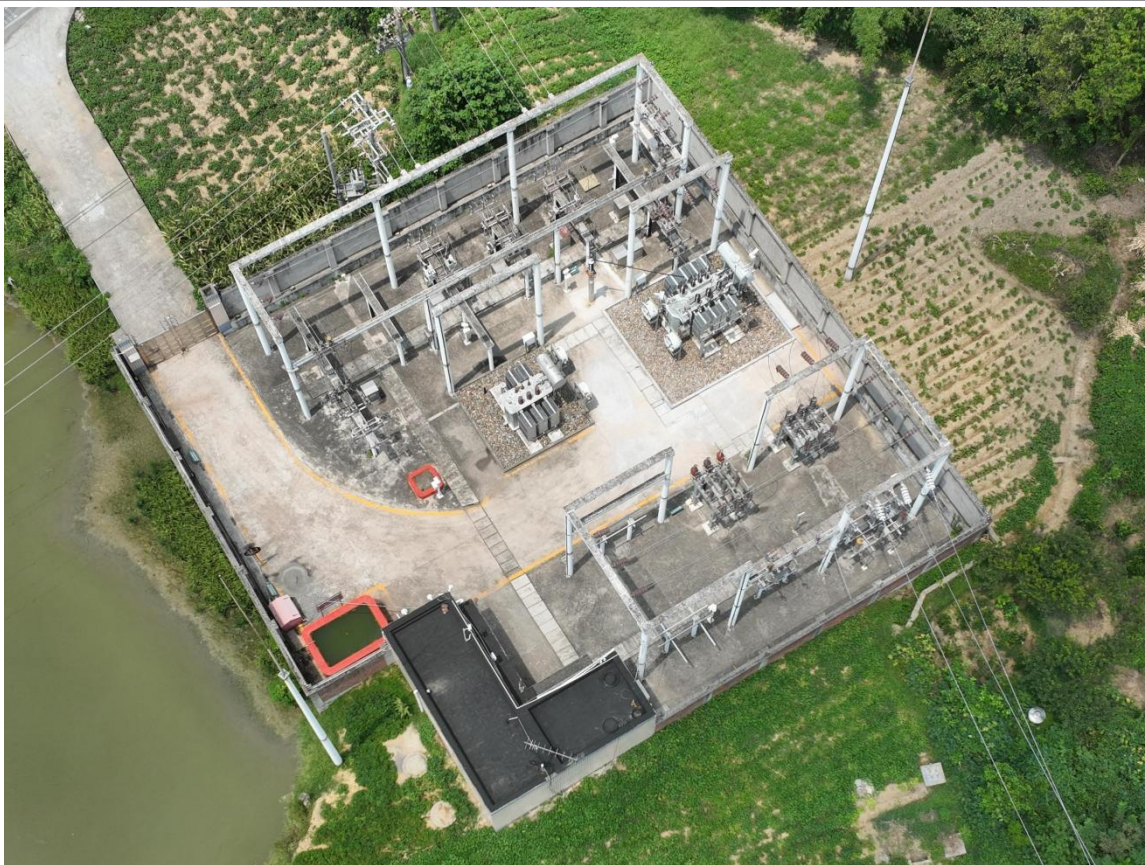
黄家 35kV 变电站
