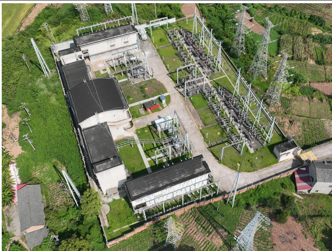
平安 110kV 变电站
