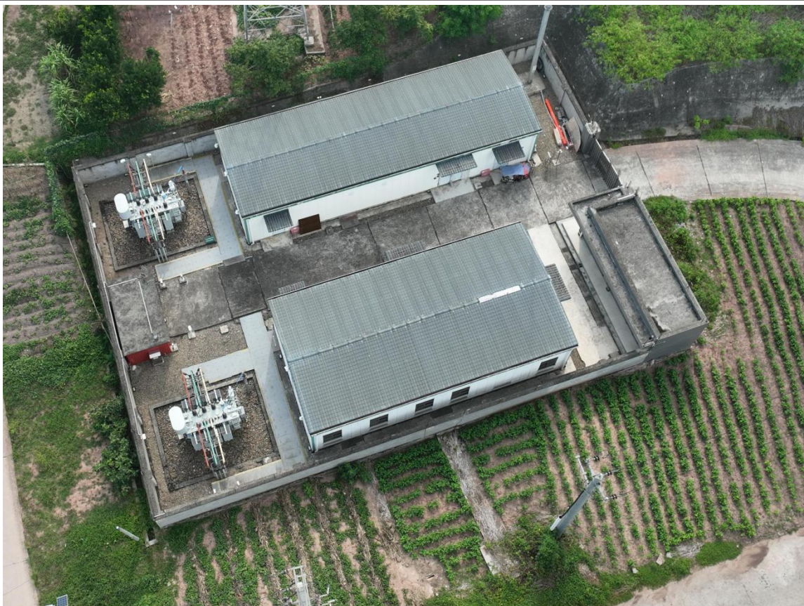
塘边 35kV 变电站
