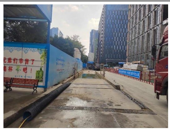
车辆冲洗设施（2024.01）
