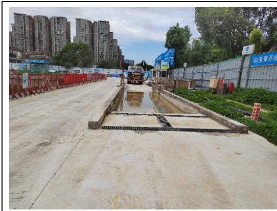
车辆冲洗设施（2023.01）
