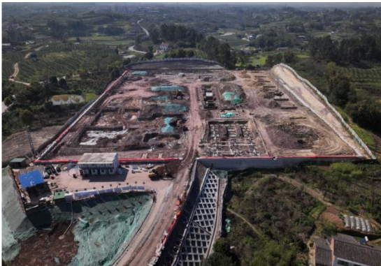
变电站站区全景
