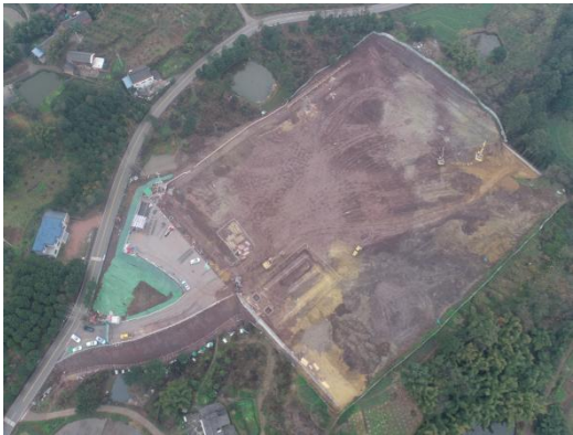
变电站站区全景
