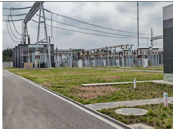
站内 2#主变预留位置
