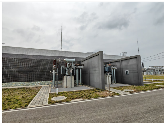
站内现有站用变及蓄电池室
