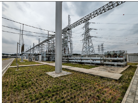
站内 220kV 配电装置区
