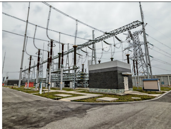
站内 500kV 配电装置区
