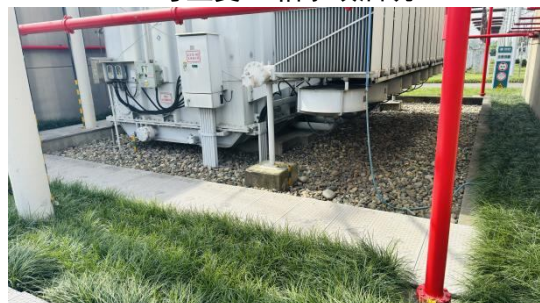
2 号主变 A 相事故油坑
