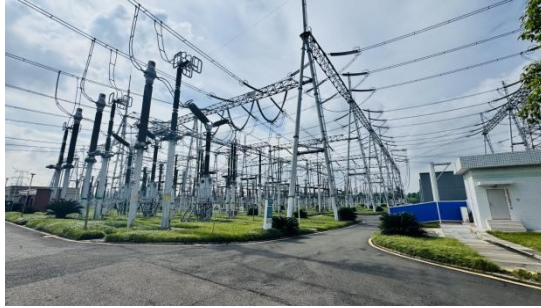
500kV 配电装置
