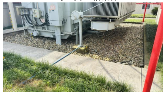
1 号主变 A 相事故油坑
