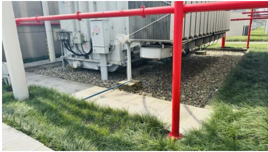
2 号主变 C 相事故油坑
