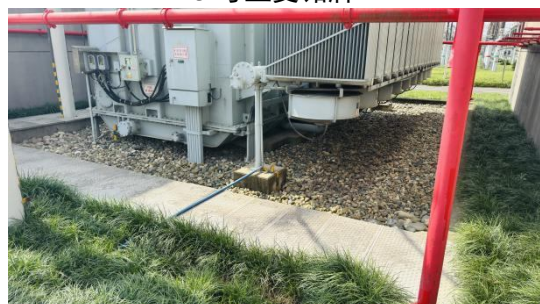
1 号主变 B 相事故油坑
