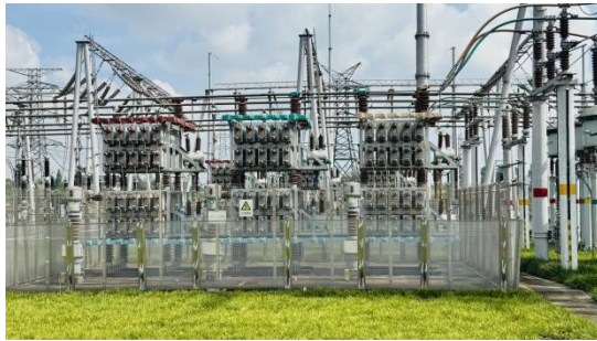
35kV 低压电容
