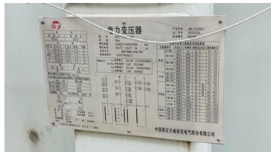
1 号主变 B 相铭牌
