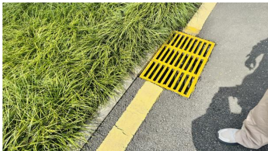
站内雨水管网
