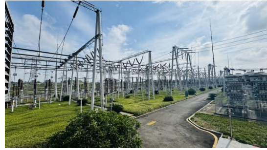
220kV 配电装置
