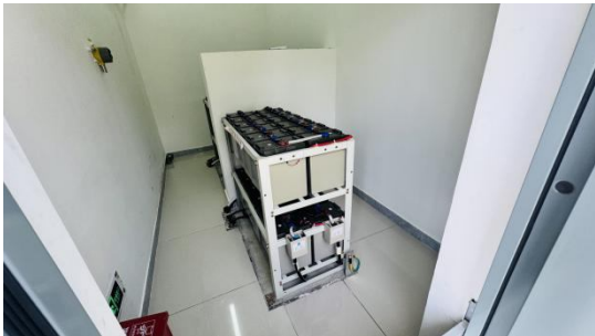
站内蓄电池室
