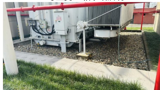
2 号主变 B 相事故油坑
