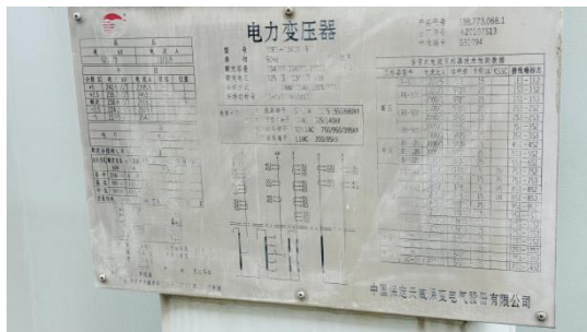
1 号主变 A 相铭牌
