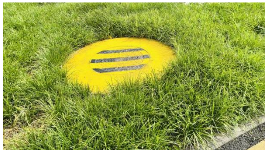
站内污水管网
