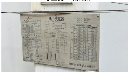
2 号主变 B 相铭牌
