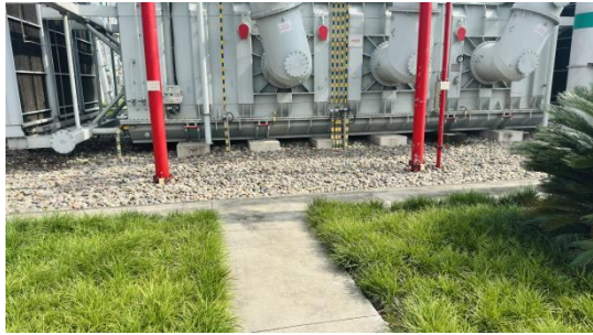
3 号主变事故油坑
