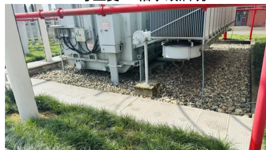
1 号主变 C 相事故油坑
