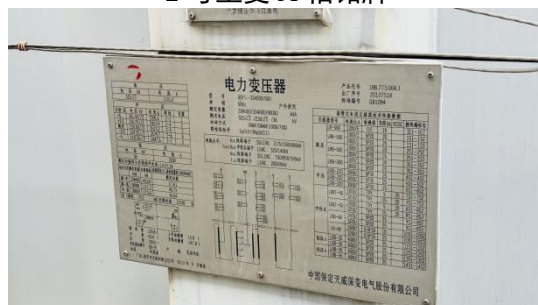
2 号主变 C 相铭牌
