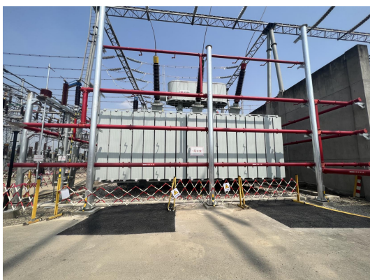
新建 1#主变压器
