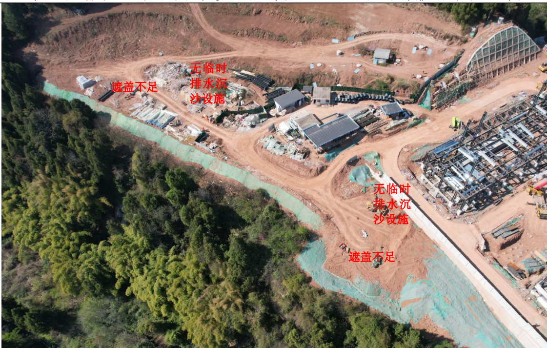
施工临时场地区闲置裸露区域、临时堆土采取的临时遮盖不到位，临时排水沉沙不完善
