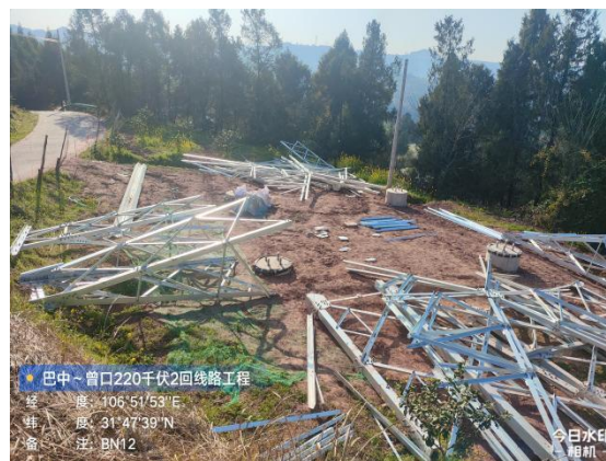
巴中~曾口Ⅱ回 N12 临时遮盖
