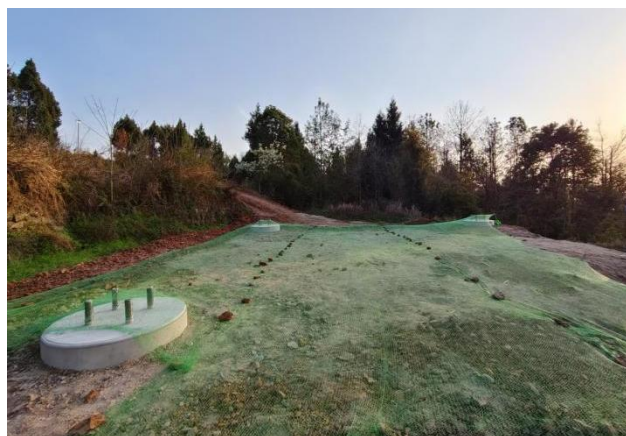
巴中~曾口Ⅱ回 N18 临时遮盖
