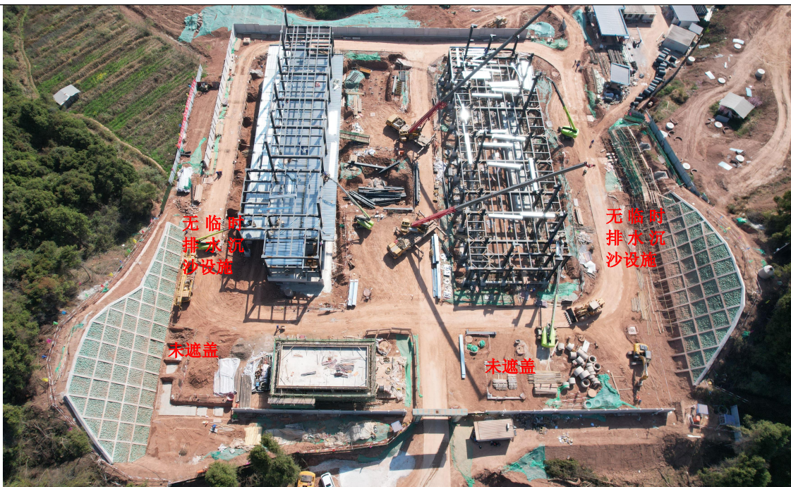
站区闲置裸露区域采取的临时遮盖范围不足，施工区域周边临时排水沉沙设施不足
