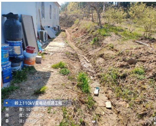
施工场地周边临时排水沟未及时清淤，且缺乏沉沙措施
