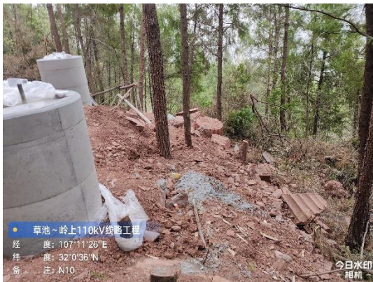
草池—岭上 N10 塔临时堆土散乱，坡地临时堆土未实施临时挡护措施
