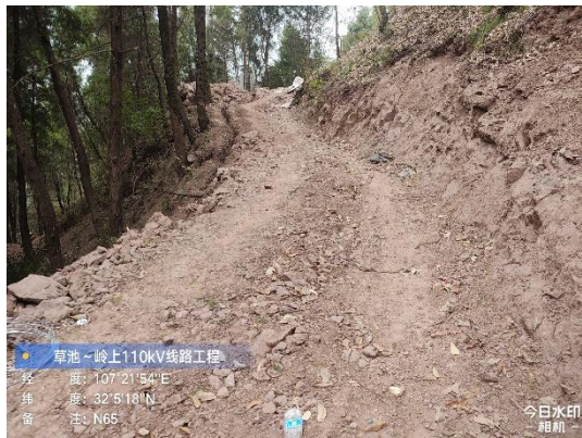
草池—岭上 N65 塔汽运道路未合理开展表土剥离及堆存保护，挖填坡面未及时采取苫盖措施，未及时采取临时排水、沉沙措施
