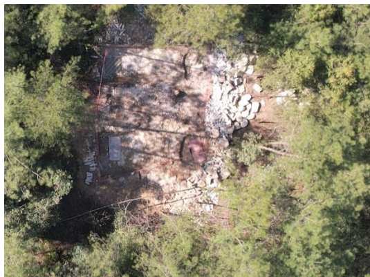
草池一岭上 N75 塔土石方堆放散乱，未合理开展表土剥离及堆存保护，临时苫盖措施不完善
