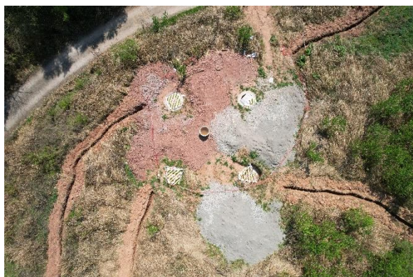
永安一岭上 N32 塔未合理开展表土剥离及堆存保护，临时铺垫、苫盖措施不完善
