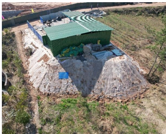
临时堆土场周边缺乏临时拦挡、排水、沉沙措施
