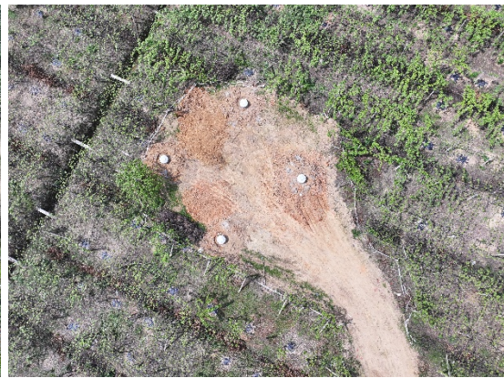
图5-2 塔基施工前表土未进行剥离
