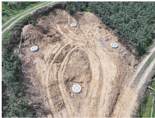
图5-1 临时堆土无苫盖
