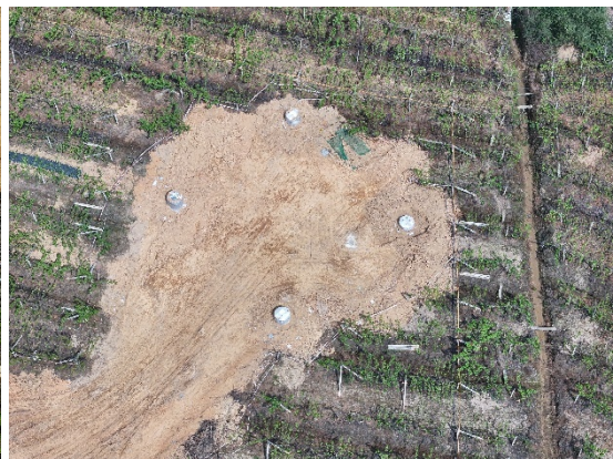
图5-4 塔基区缺少苫盖措施
