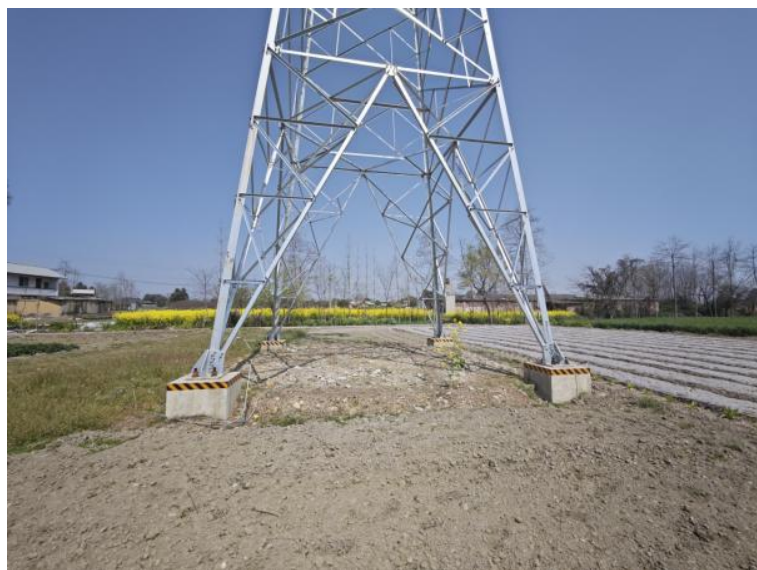
图 4.3-11 N30 已组塔塔基，永久占地区域土地整治差，未进行撒播草籽
