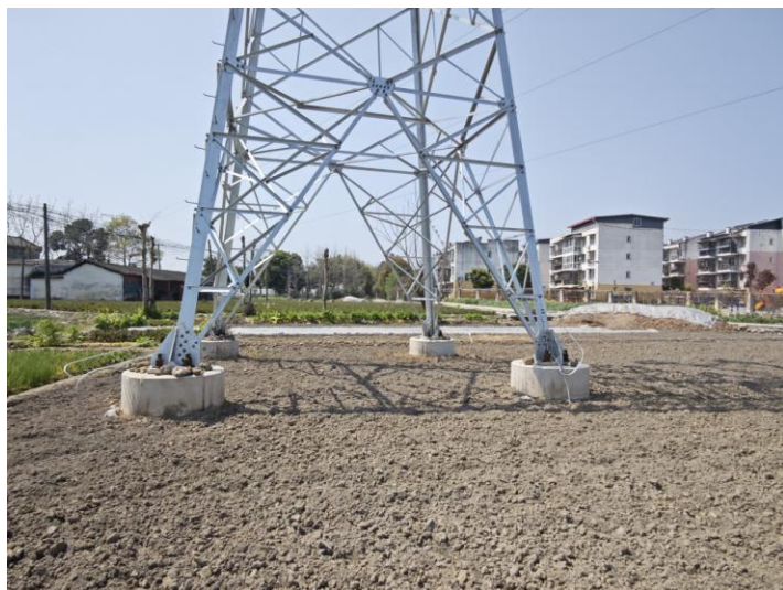
图 4.3-14 N51 已组塔塔基，永久占地区域土地整治差，未进行撒播草籽
