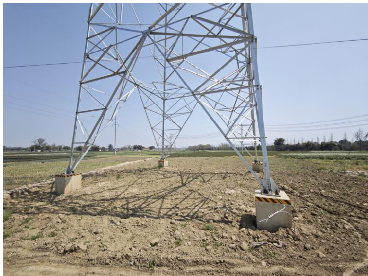
图 4.3-13 N44 已组塔塔基，永久占地及施工临时占地区域土地整治差，未进行撒播草籽
