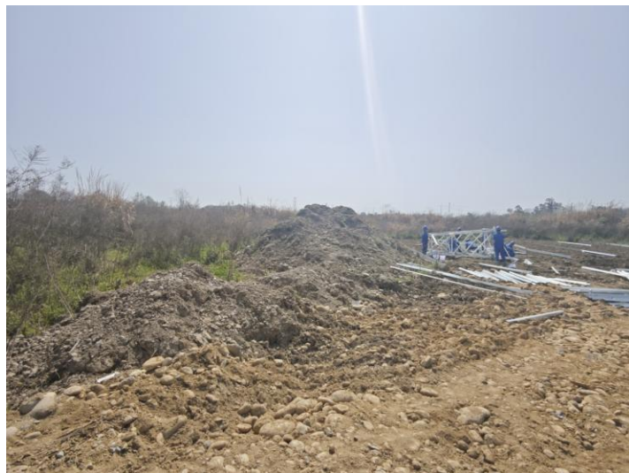
图 4.3-2 N19 塔基及施工临时占地区域，存在临时堆存土石方未进行摊平处理，且堆存过程中未用防雨布进行遮盖
