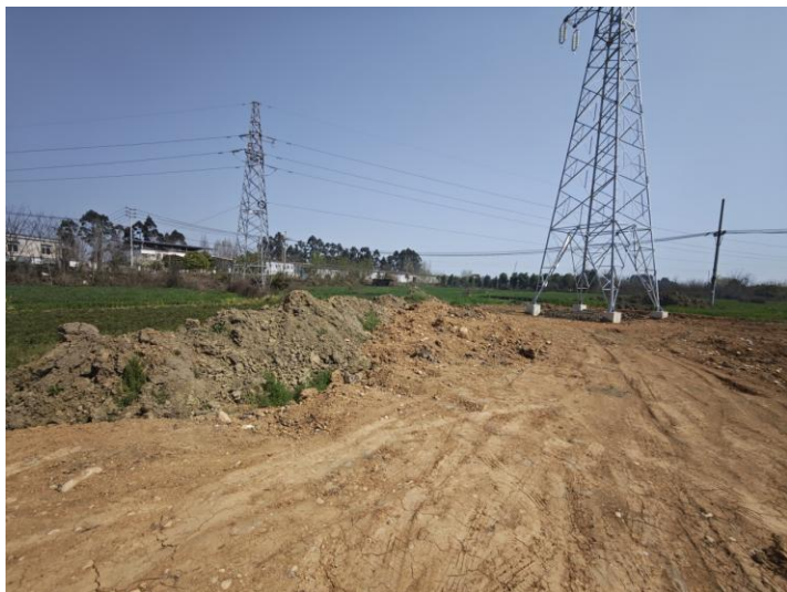
图 4.3-1 N73 塔基及施工临时占地区域，存在临时堆存土石方未进行摊平处理，且堆存过程中未用防雨布进行遮盖
