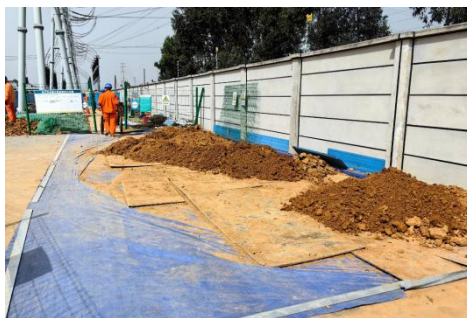
新津 500kV 变电站 220kV 间隔扩建区域
