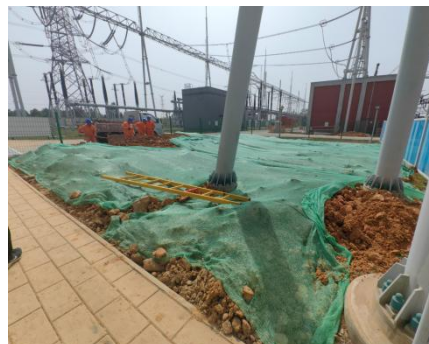
新津 500kV 变电站 220kV 间隔扩建区域
