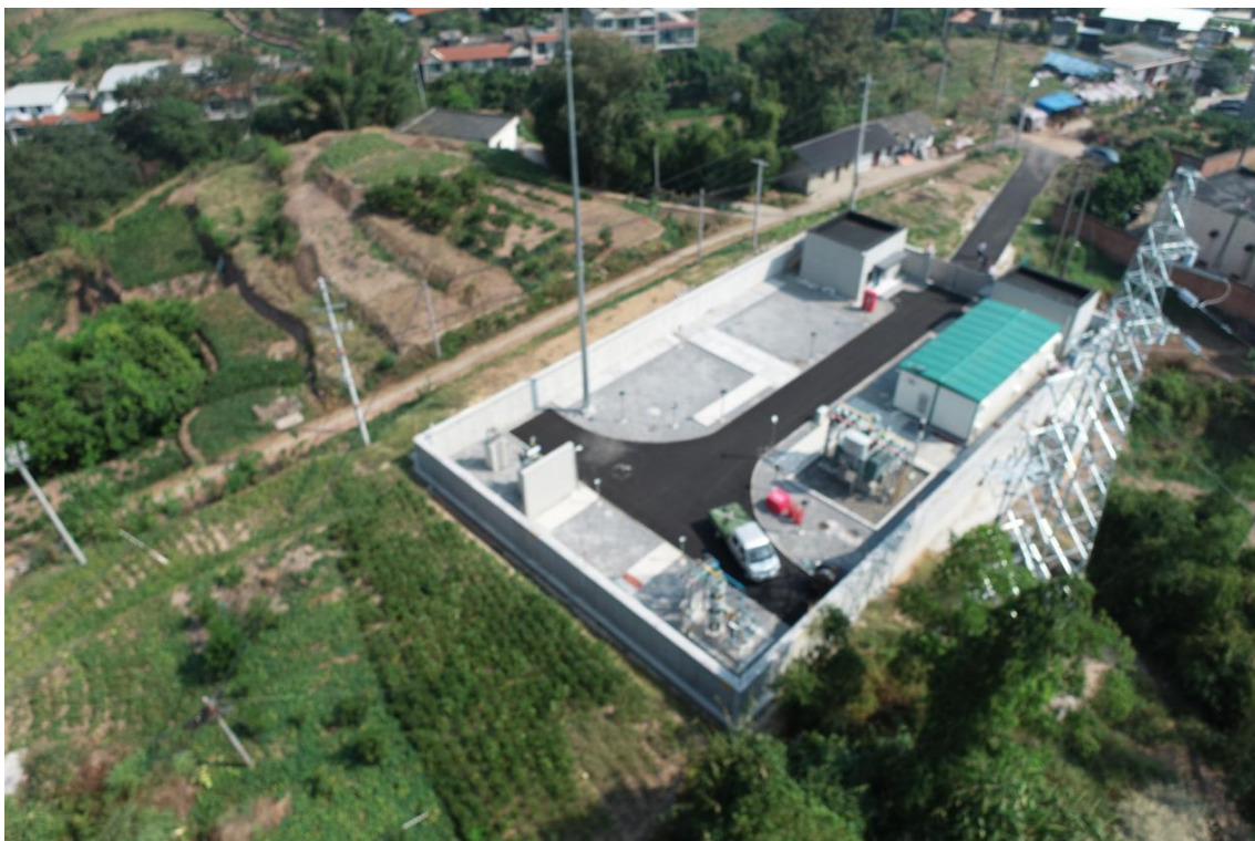
牟坪变电站现状
