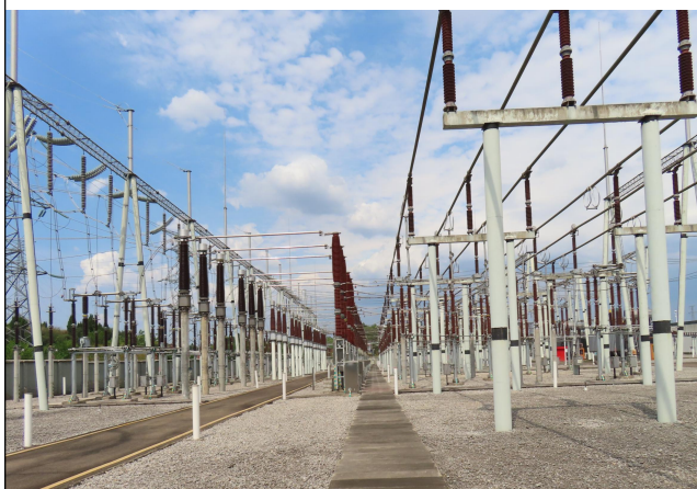
永安 220kV 变电站-220kV 配电装置场区
