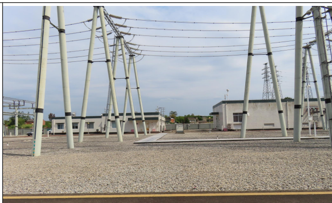
永安 220kV 变电站-1 号主变压器预留场地
