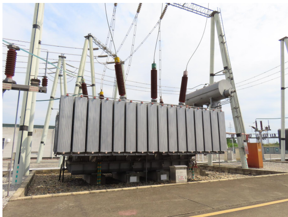
永安 220kV 变电站-已有主变压器
