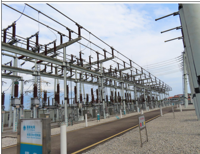
永安 220kV 变电站-110kV 配电装置场区
