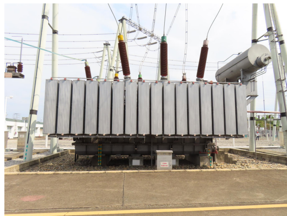
永安 220kV 变电站-已有主变压器
