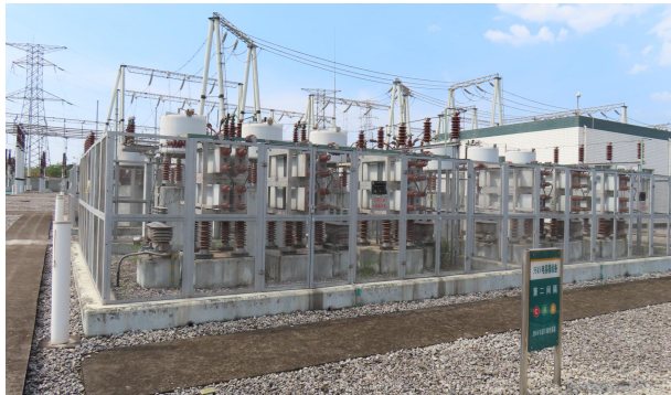
永安 220kV 变电站-35kV 电容器组场区
