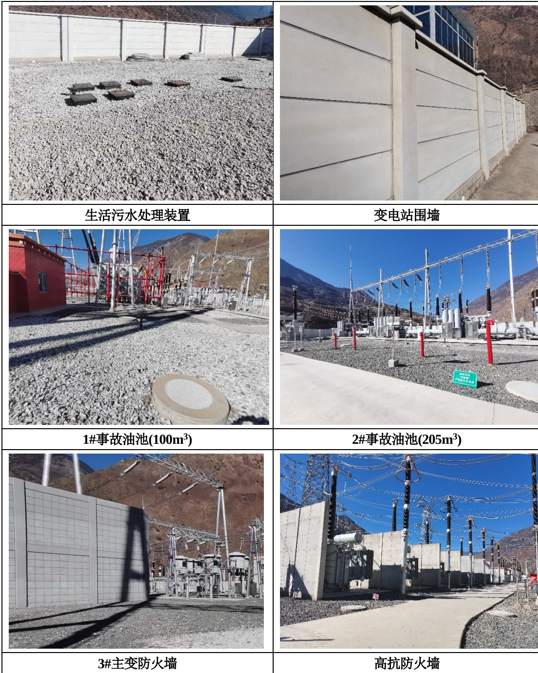
图 3-3 500kV 水洛变电站内现有环保措施
