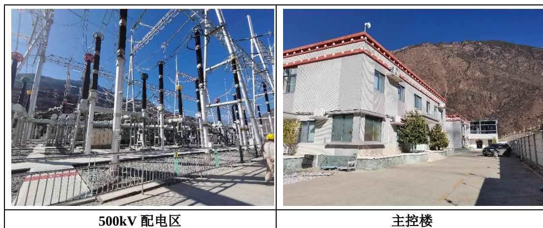
图 3-2 500kV 水洛变电站现状
