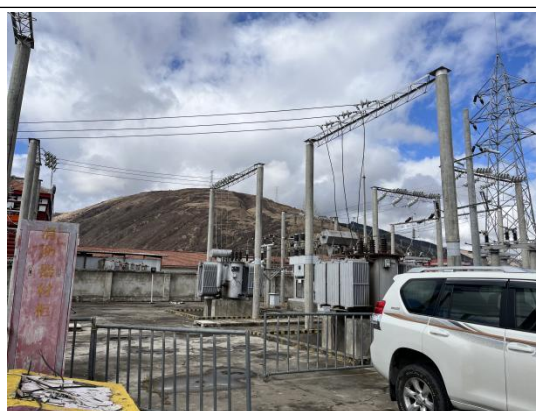
仁达 35kV 变电站现状
