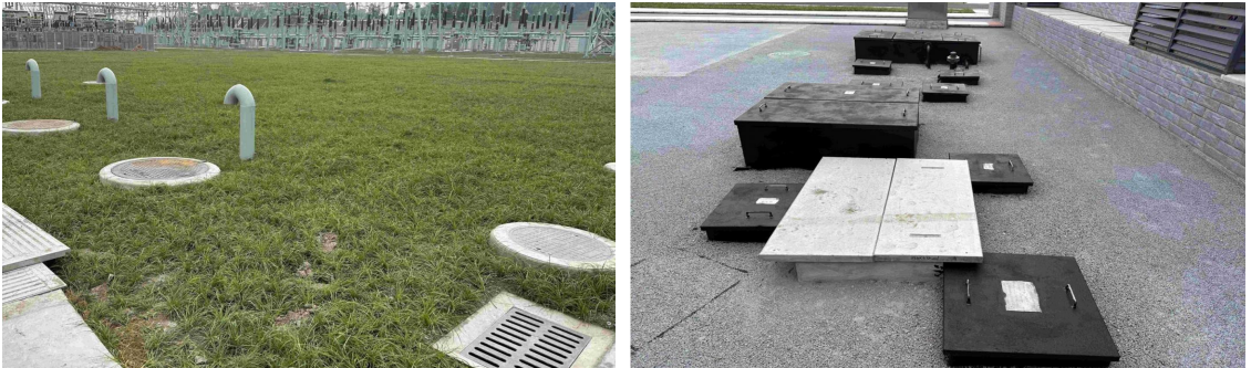
站内主变压器事故油池 站内地埋式污水处理装置
