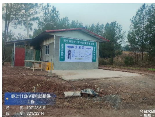
施工临时场地周边缺乏临时排水、沉沙措施
