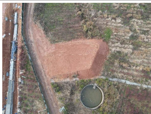
施工临时场地裸露面未及时采取苫盖、铺垫措施
