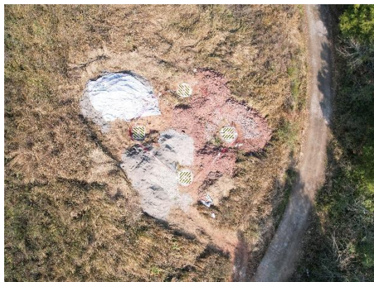
永安—岭上 N32 塔施工开挖未合理开展表土剥离及堆存保护，临时铺垫、苫盖措施不完善
