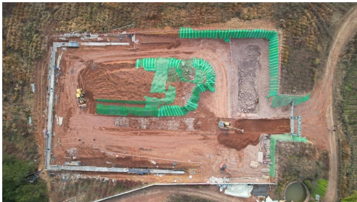
站区闲置裸露地表及临时堆土区域采取的苫盖范围不足，表土应单独堆放并采取土袋挡护、苫盖防护，站区周边缺乏临时排水、沉沙措施
