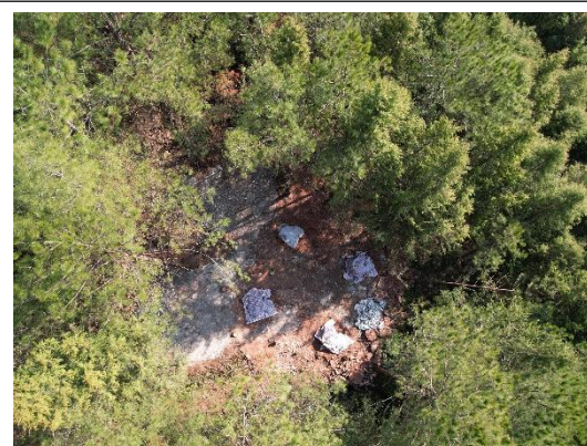
永安—岭上 N30 塔施工开挖未合理开展表土剥离及堆存保护，临时铺垫、苫盖措施不完善
