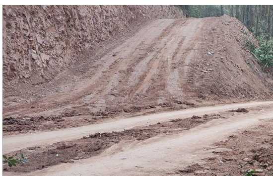
草池~岭上 N61 塔汽运道路未合理开展表土剥离及堆存保护，挖填坡面未及时采取苫盖措施，未及时采取临时排水、沉沙措施
