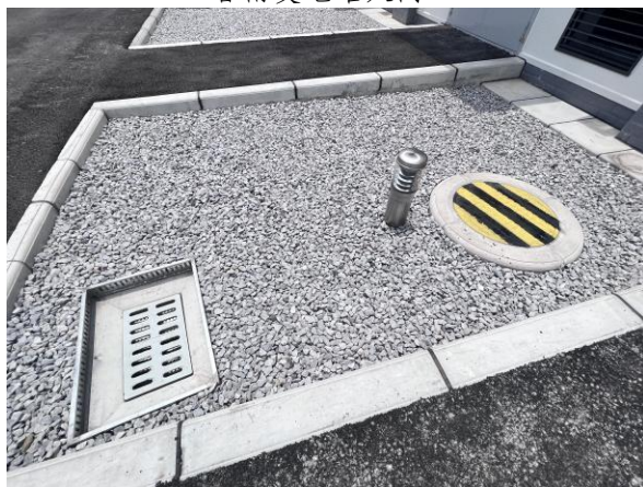
站内排水系统现状
