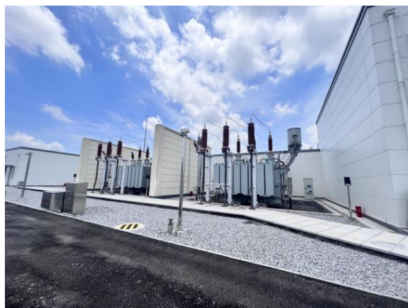
主变油坑及基础
