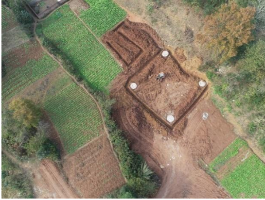
图5-1 临时堆土无苫盖
