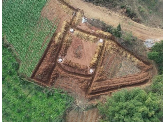
图5-2 接地线沟堆土未苫盖
