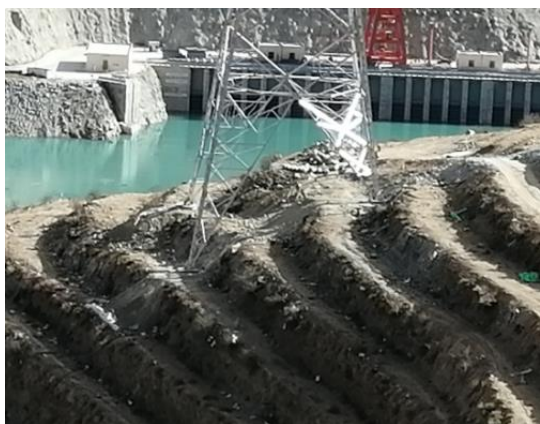
2#塔基 余土未及时清运
