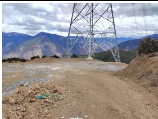
62#塔基 植物措施滞后
