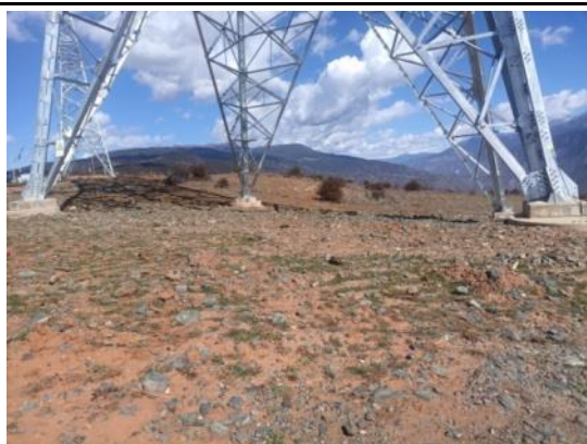
136#塔基 植物措施管护不当
