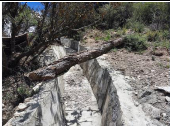
排水沟未清理
