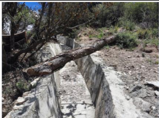
排水沟未清理
