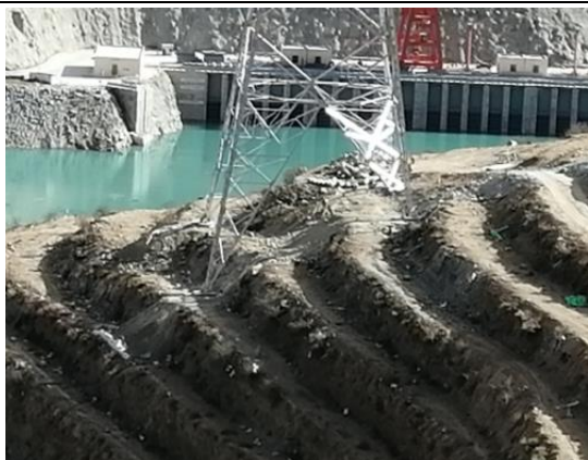
2#塔基 余土未及时清运
