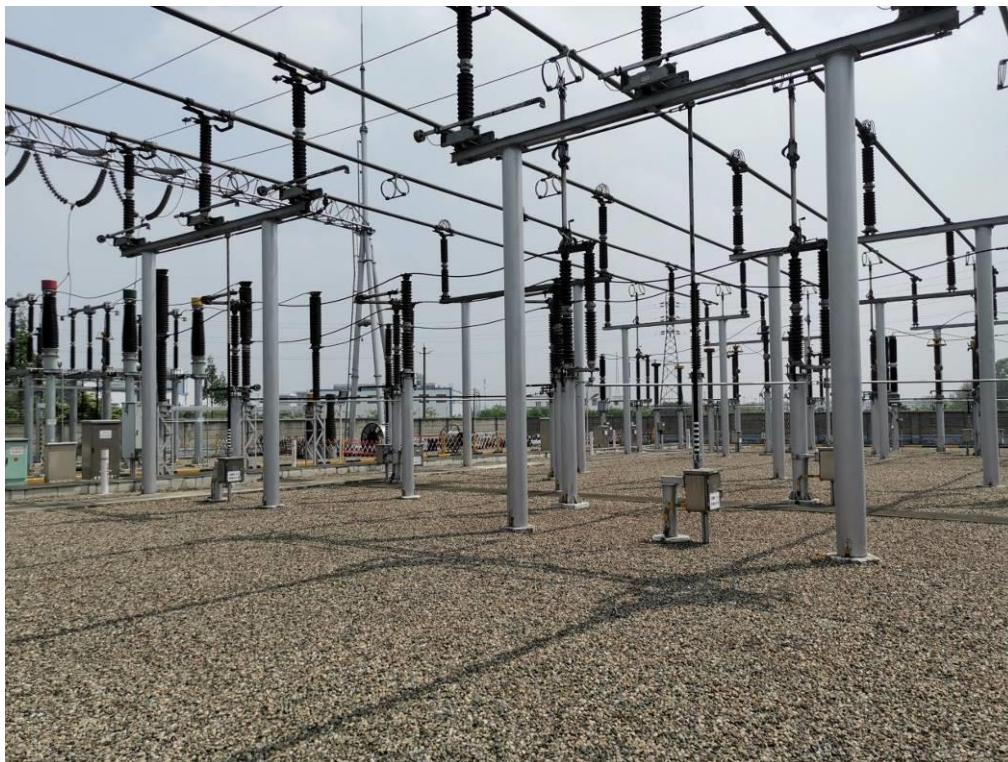
团结站 220kV 预留间隔现状
