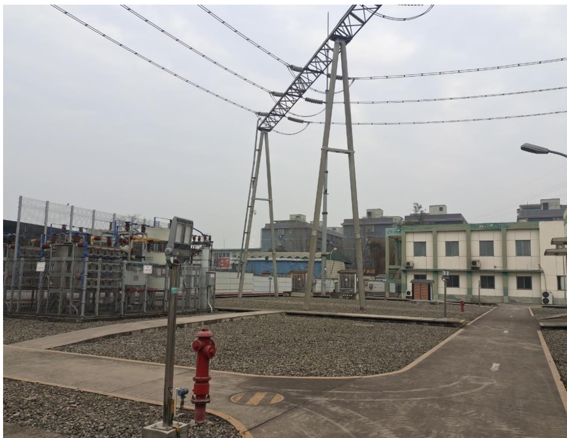
斑竹园 220kV 预留间隔现状
