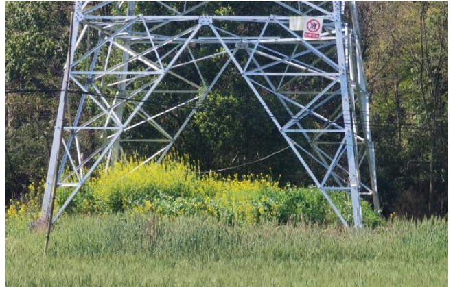
48#铁塔（新建 N8#）
