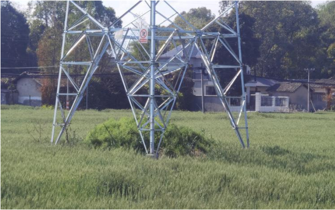
47#铁塔（新建 N7#）
