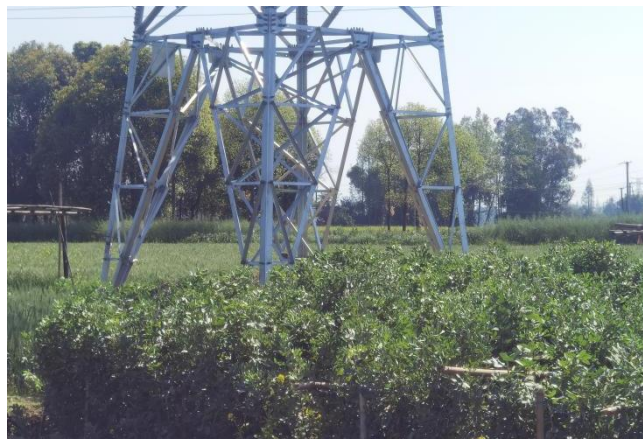
42#铁塔（新建 N2#）
