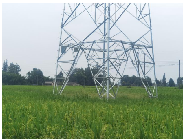
45#铁塔（新建 N5#）
