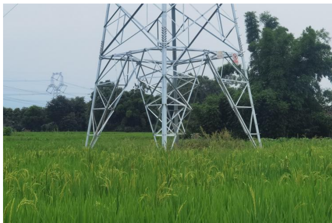
41#铁塔（新建 N1#）
