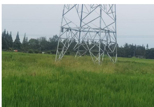
44#铁塔（新建 N4#）
