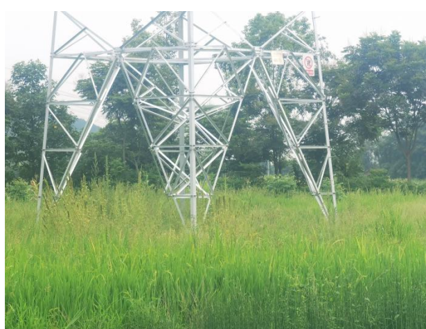
46#铁塔（新建 N6#）
